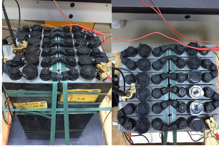
Şekil 3.17. Şebeke sisteminde kullanılan enerji depolama sistemi
