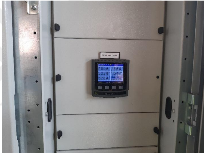
Şekil 4.6. Pano tipi test analizör
