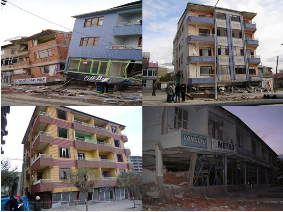
Şekil 3.9. Van depremlerinde yumuşak kat düzensizliğinden kaynaklanan bina hasarları
