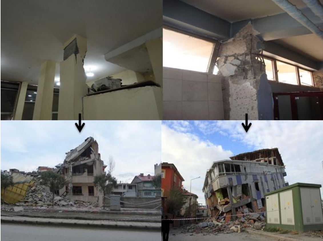
Şekil 3.11. Van depremlerinde kısa kolon düzensizliğinden kaynaklanan bina hasarları
