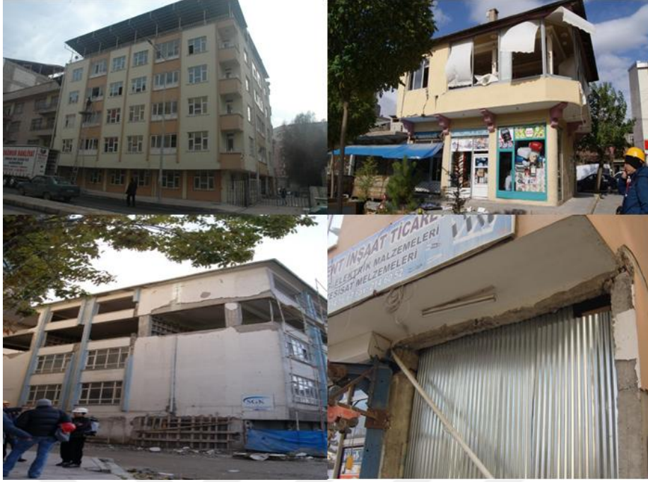
Şekil 3.13. Van depremlerinde ağır çıkma düzensizliğinden kaynaklanan bina hasarları
