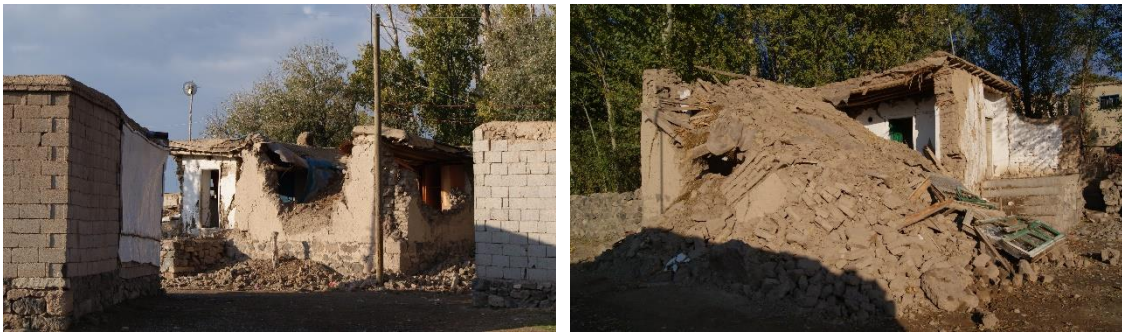
Şekil 2.1. Van'ın Çakır Bey köyünde gözlenen yığma bina hasarları (Akansel ve ark., 2014).
