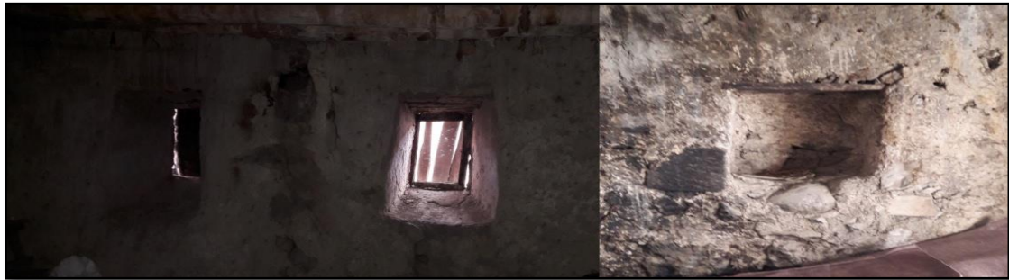
Şekil 4.33. Pencereilerin içten görünümü ve sofada yer alan niş.
