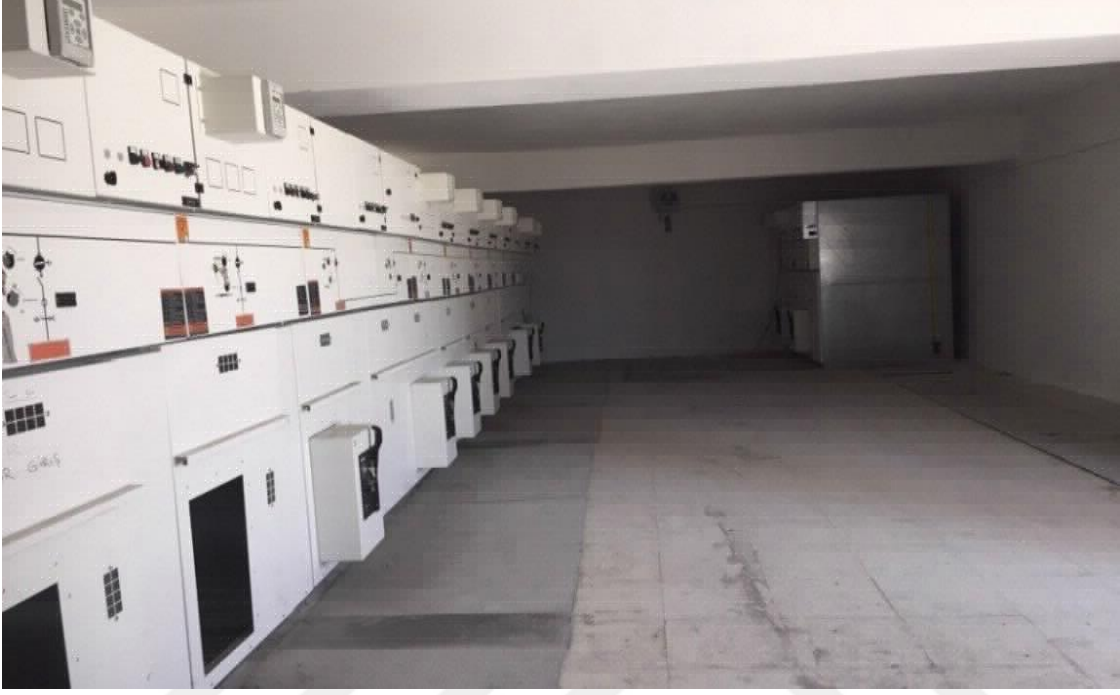
Şekil 3. 2. Van M8 dağıtım merkezindeki metal mahfazalı hücreler.
