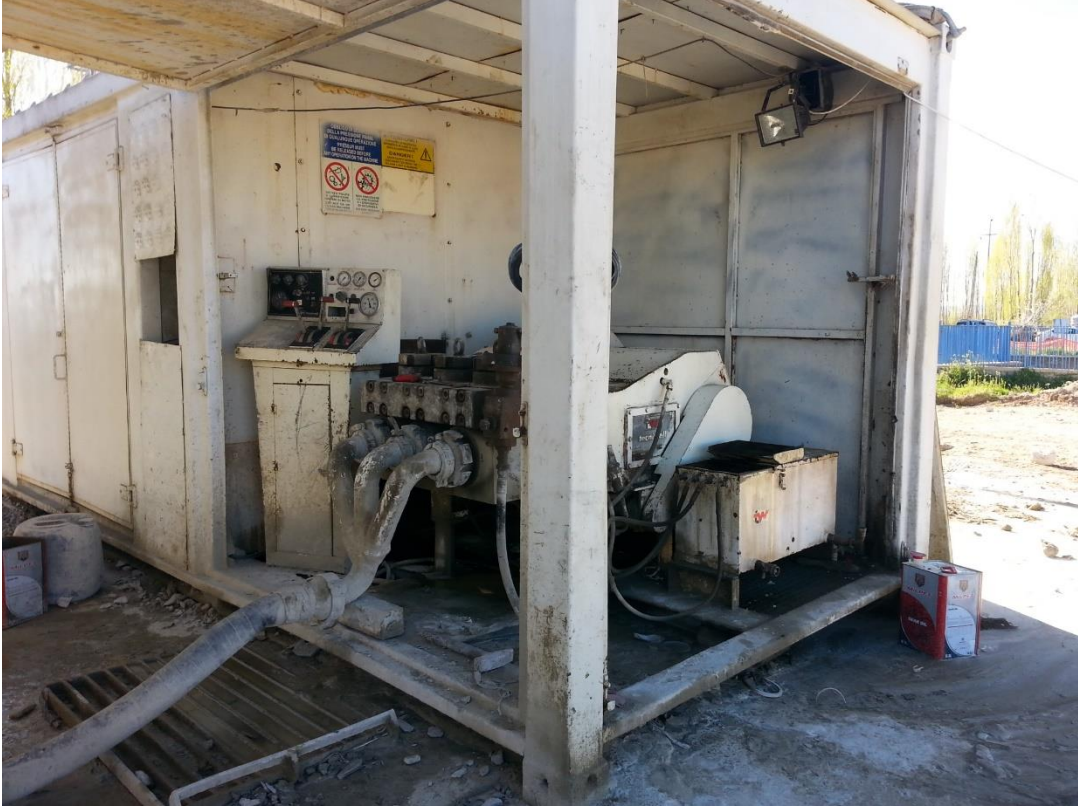
Şekil 1.10. Jet Grout pompa ünitesine ait bir görüntü.
