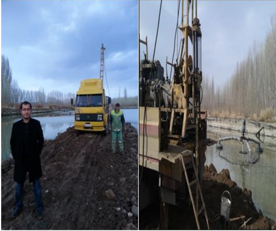
Şekil 4.2. Jet Grout öncesinde atıksu arıtma alanında yapılan sondaj çalışmalarına ait bir görüntü.
