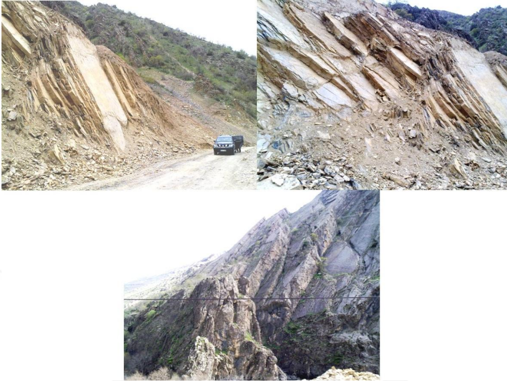
Şekil 4.31. Çukurca Tüneli giriş kısmında ÇKRC düzlemlerinde oluşan düzlemsel kaymalara ait görüntüler.
