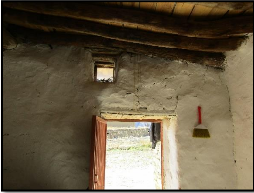
c. Alt kat giriş kapısı üstündeki küçük pencere
