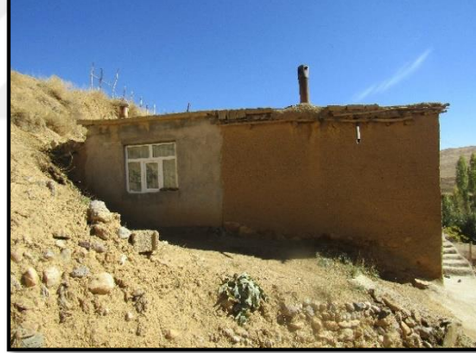
Çimento ile çamur sıvanın aynı duvarda kullanımı.
