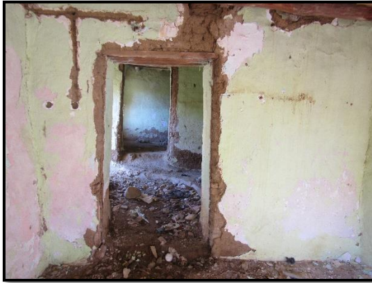
b. Bakımsızlıktan tahrip görmüş yapı kısımları.
