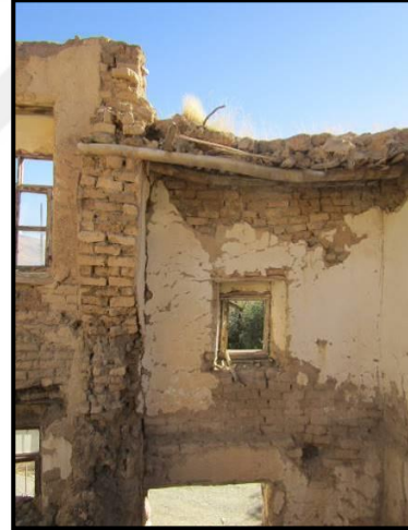
c. Yıkılan duvarlar ile üst örtü.
