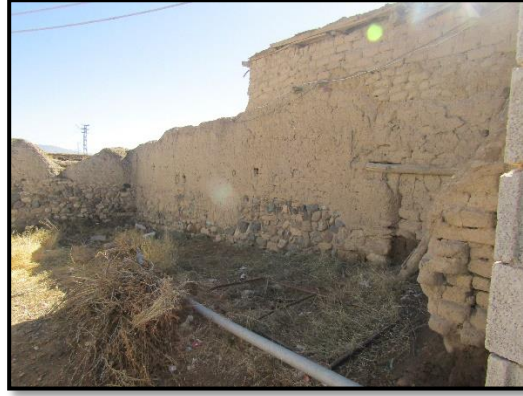
c. Yıkılan bölümlerin duvar kalıntıları.
