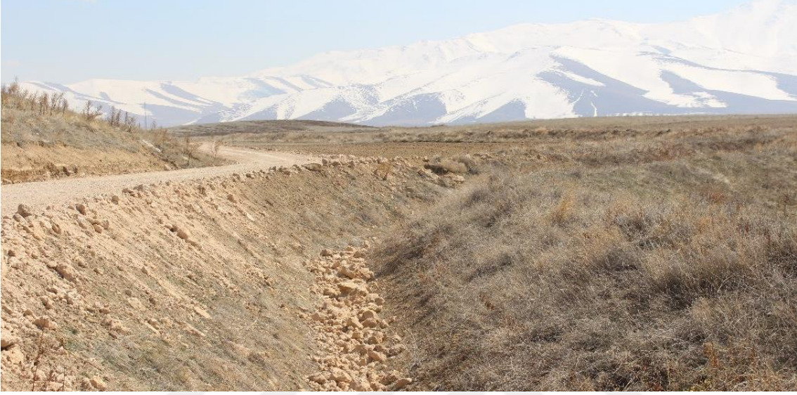
Şekil 4.14. Yol inşası nedeniyle tahrip olan kuzey kanat ve kanal içerişe dökülen inşaat malzemesi (Orjinal, 2019).
