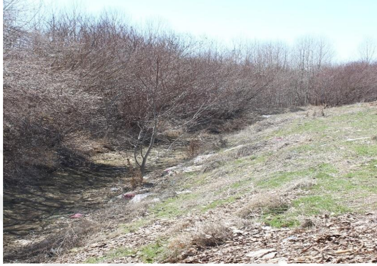
Şekil 4.11. Kanal içinde bulunan bitki ve bitki köklerinin yarattığı tahribatlara ait görseller (Orjinal, 2019).
