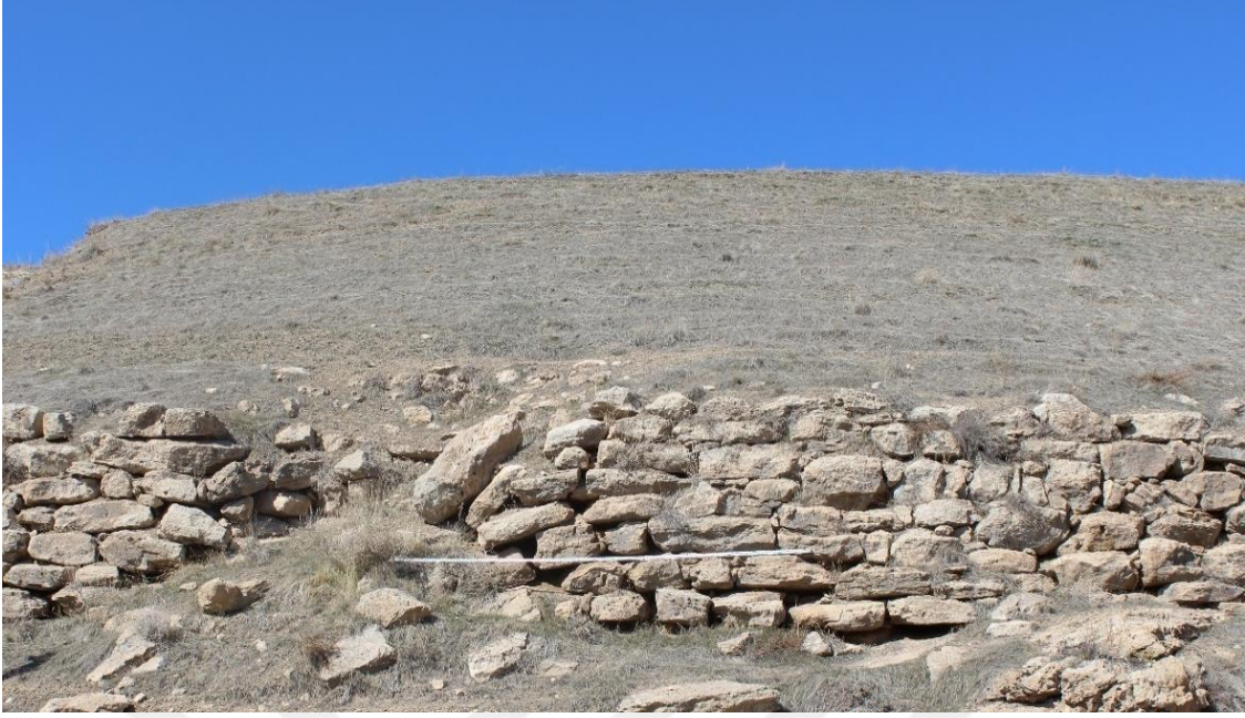
Şekil 4.10. Toprak kayması nedeniyle istinat duvarında meydana gelen tahribat (DSİ Minua (Şamram) Kanalı Restorasyon Raporu, 2018).
