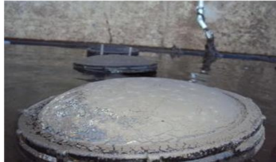
Şekil 4.3. Havalandırma havuzunda hasar gören difüzörler.
