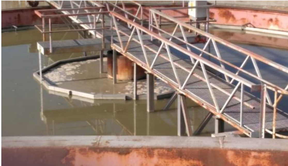
Şekil 4.32.Son çökeltim havuzu savakları.
