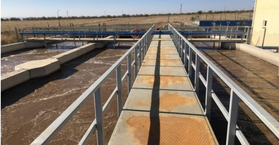
Şekil 4.14.Havalandırma havuzunda blowerların çalışması.
