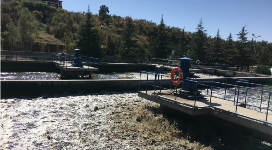
Şekil 4.3.Havalandırma havuzunda beyaz köpük.
