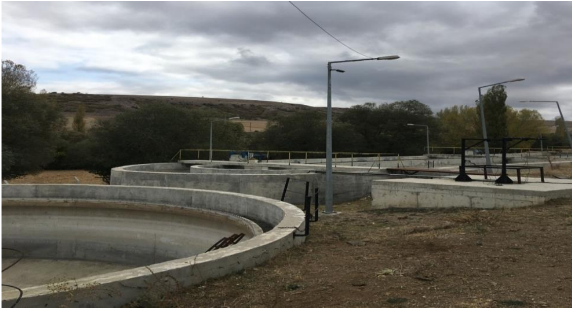
Şekil 3.5.Saraykent Belediyesi biyolojik atıksu arıtma tesisi.
