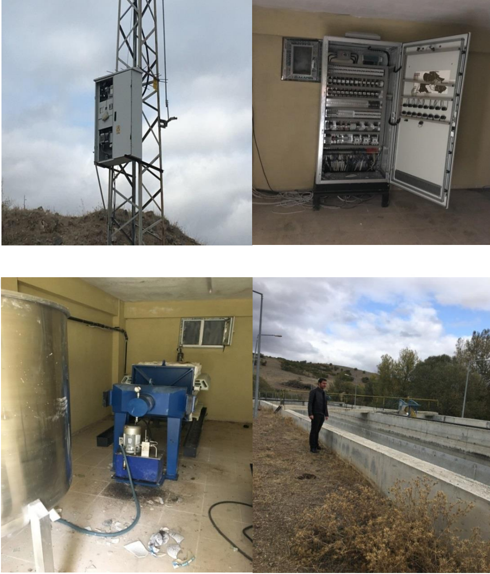
Şekil 4.12.Sarayken atıksu arıtma tesisinde problemler.
