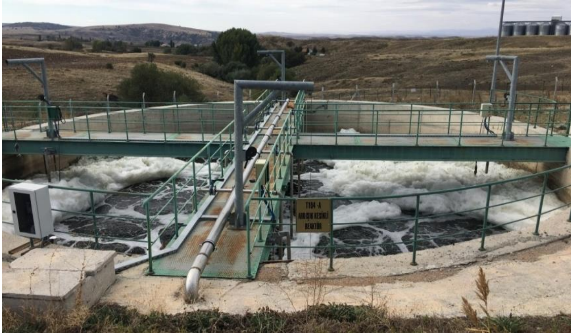
Şekil 4.8.Havalandırma havuzunda beyaz köpük.
