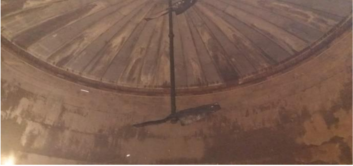
Şekil 4.30. Anaerobik havuz karıştırıcısı.
