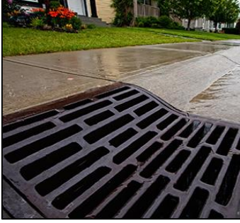
a) Kanalizasyon ızgarası
