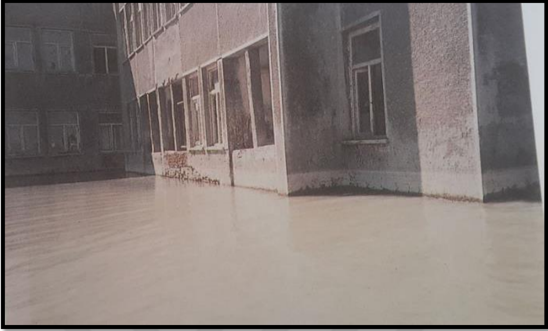
Şekil 4.18. Taşkından zarar gören Y.İ.B.O. genel görünüşü (Türkelli,1995).
