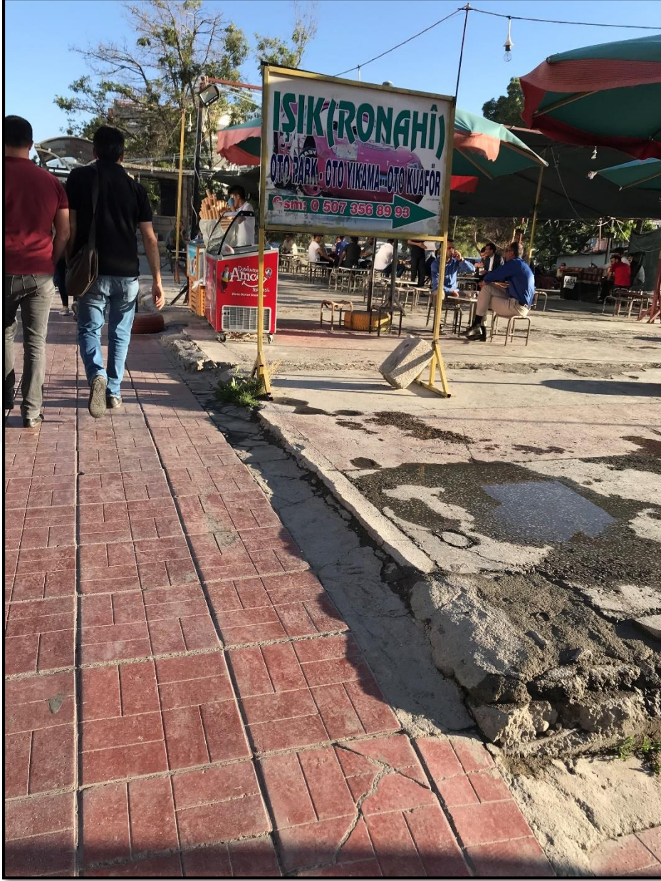
Şekil 4. 28. Hasarlı zemin kaplaması fotoğrafı.
