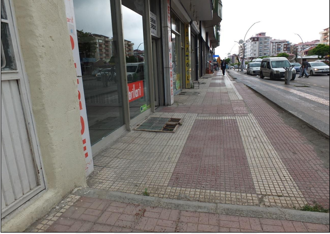
Şekil 4.86. Hasarlı zemin kaplaması.
