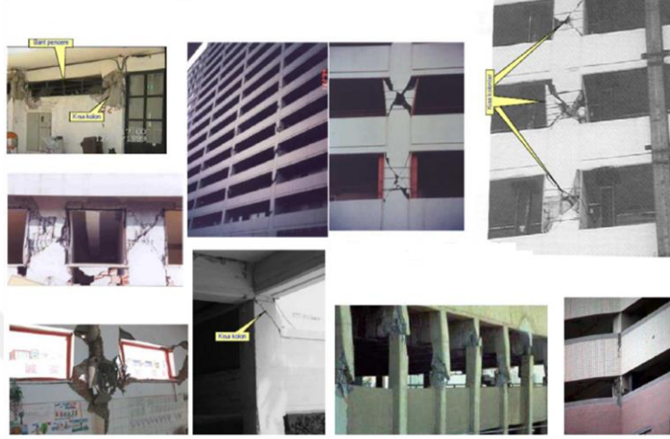
Şekil 2.10. Kısa kolon hasarları (Topçu, 2012).
