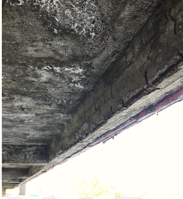
Şekil 3.5. Korozyonlu Betonarme Kiriş (Erzincan Kapalı Olimpik Havuzu, 2018)
