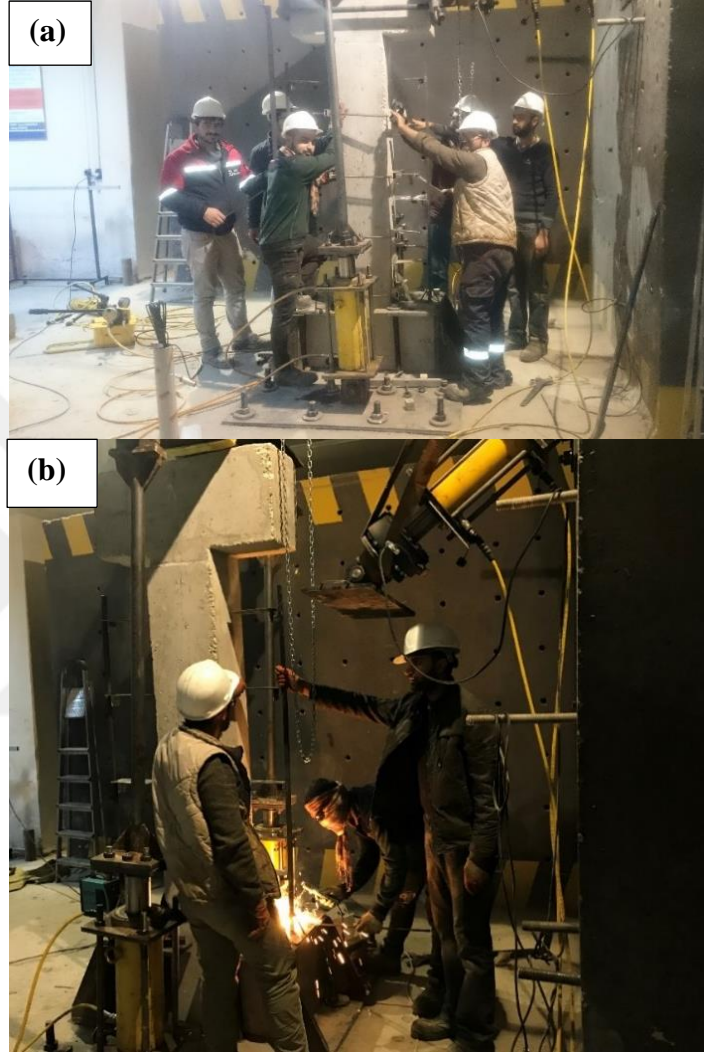
Şekil 3.26. Deney düzeneği kurumu: (a) Ölçüm düzeneklerin kurulması, (b) Deney düzeneğinin kaynak işleri.
