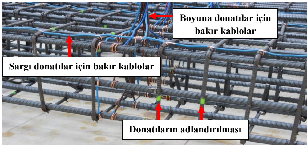
Şekil 4.23. Donatılara bağlanan bakır kablolar.
