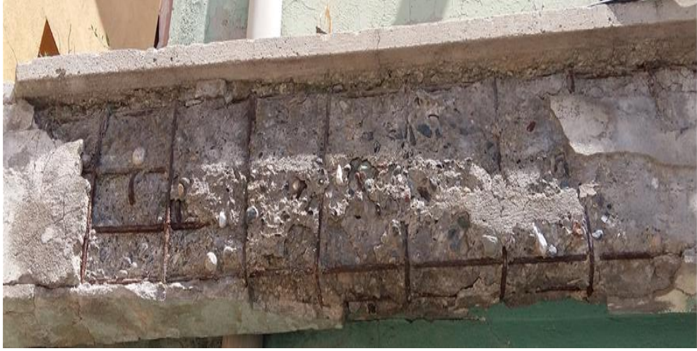
Şekil 3.2. Korozyon sonucu giriş tüm yüzey bölgesinde oluşan hasar (Erzincan, 2019).
