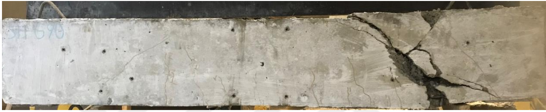
Şekil 4.9. SH-G90 numunesinin çatlak gelişimi
