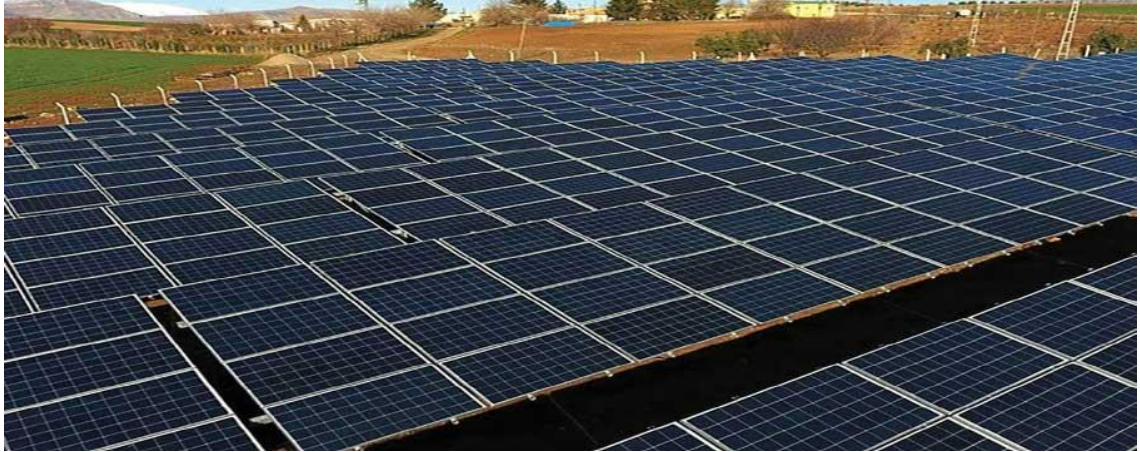
Şekil 4.6. Güneş Enerjisi Santrali (Enerji Portalı, 2019).
