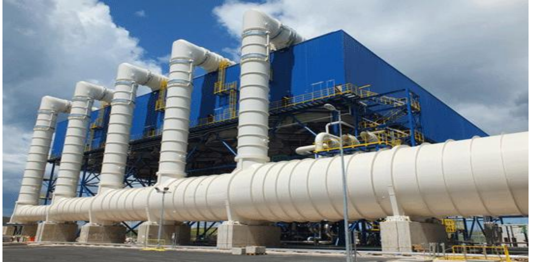
Şekil 5.11. Hava Soğutmalı Kondenser (ACC) (B&W SPIG, 2019).
