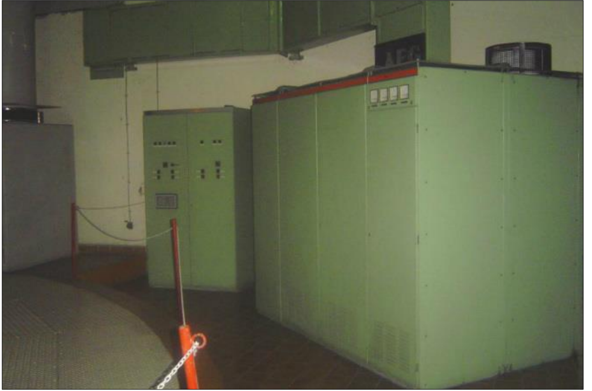
Şekil 2.12. Keban HES 5 No.lu ünite statik uyartım panoları Elektrikport (2019)
