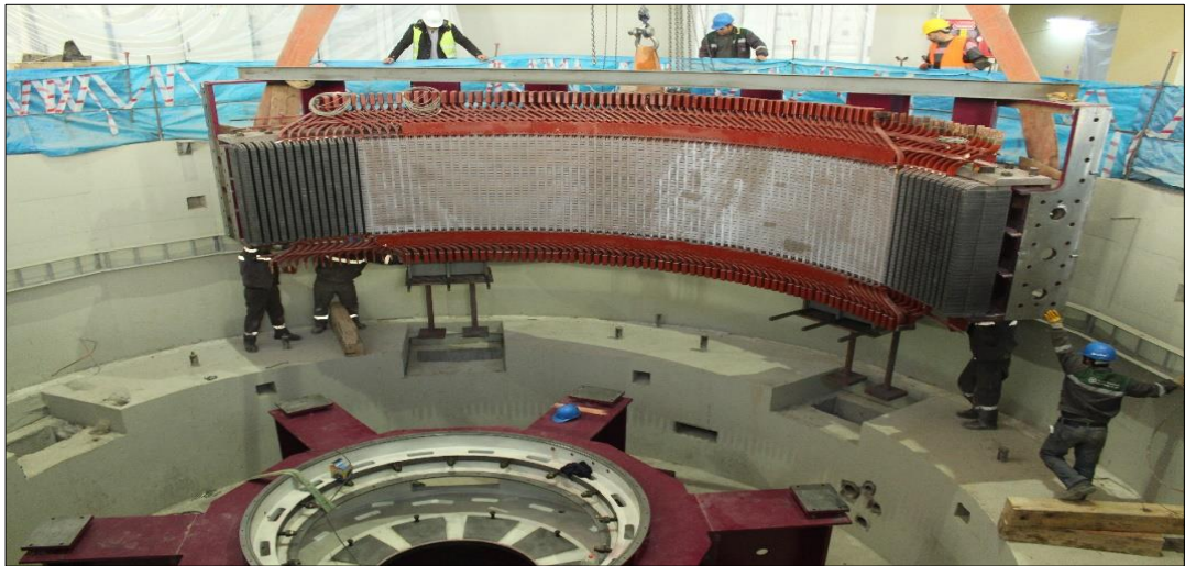
Şekil 2.2. Bağıştaş I HES 44 MW senkron generatör stator sargıları
