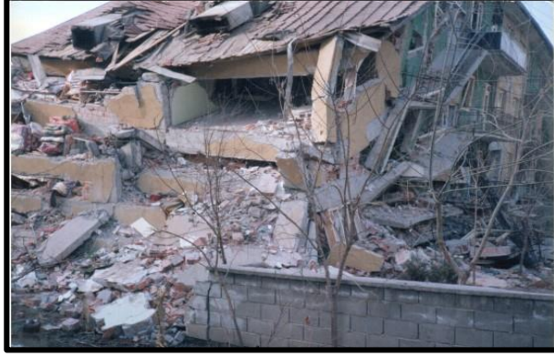
Şekil 4.8. 1992 Erzincan Depreminde yüksek katlı yapılarda meydana gelen hasar (Doğu Gazetesi, 2020)
