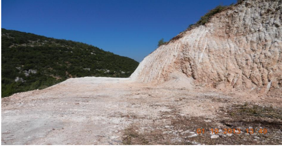
Şekil 5. Yayladağı Sungur ve Sürütme köyleri arasındaki yol yapım çalışmasında açığa çıkan asbestli alan görülmektedir.
