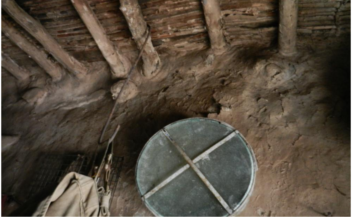
Şekil 30. Şakşak köyünde sıvasında asbest kullanılmış bir ev
