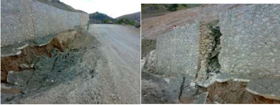
Şekil 2.21 Heyelan sebebiyle Taşkent-Balcılar yolunun bozulan kısmı (sol) ve İksa duvarındaki Deformasyon (sağ) (Zeybek 2013)
