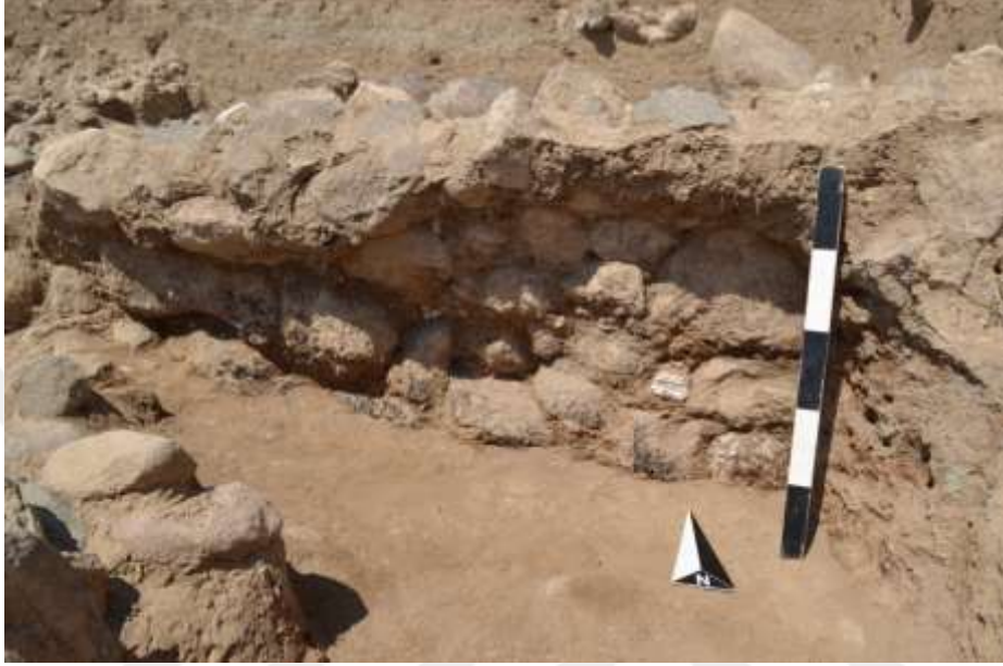
Şekil 3.3 Erozyon etkisi ile deforme olan kısımlar
