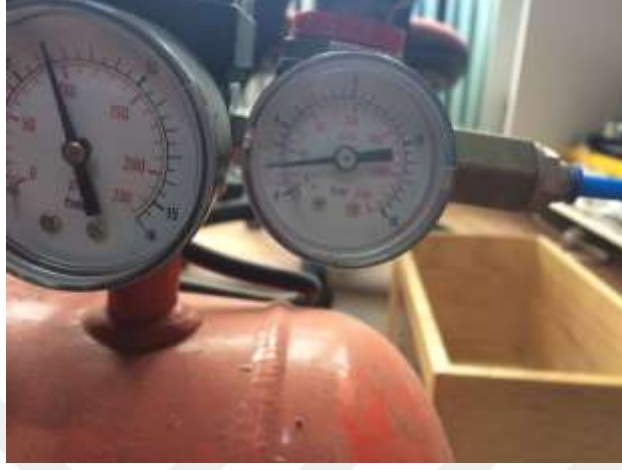
Şekil 2.7 Test basıncı manometre görseli
