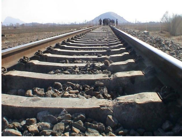
Şekil 3.8 Yük aktarımı sorunları sebebiyle çatlamış beton traversler (Zakeri ve Rezvani 2012)
