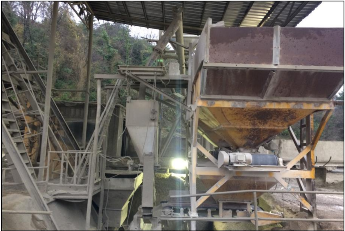
Şekil 6.15 Kuru karışım beton santrali yan görünümü.
