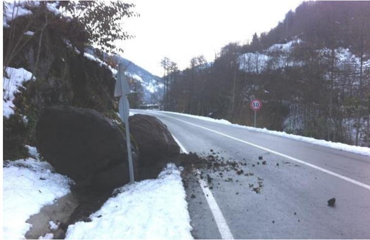
Şekil 6.9 Kanal içine düşmüş kaya blokları (URL-6)
