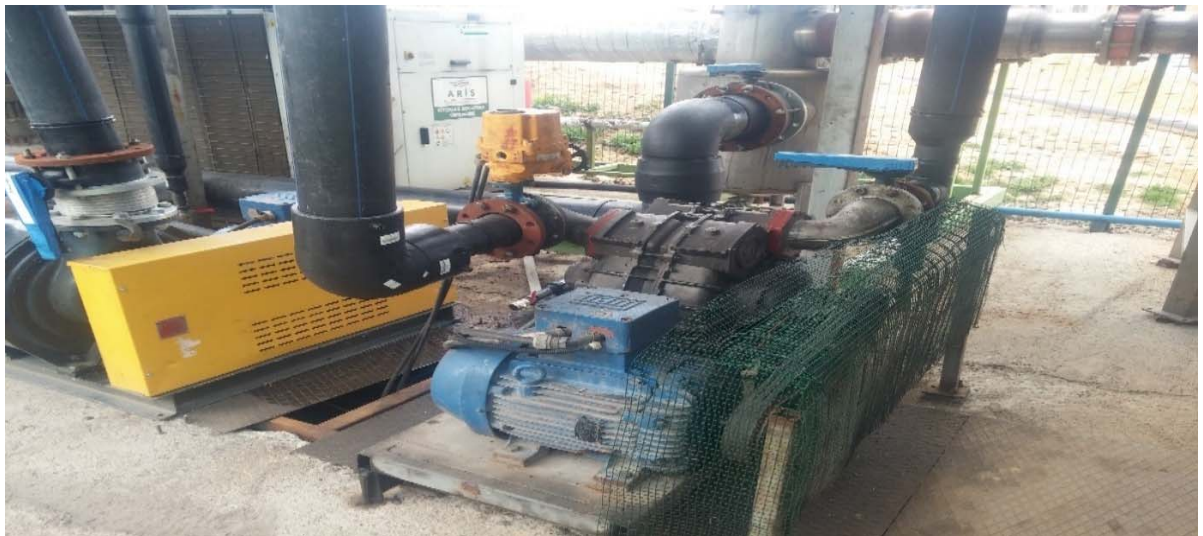
Şekil 6.8 Blower sisteminin genel görünümü (anonim).
