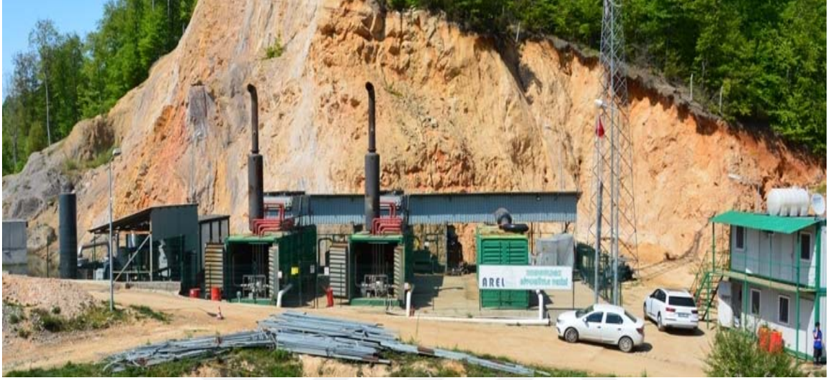
Şekil 6.7 Enerji tesisi genel görünümü (anonim).
