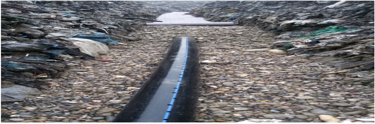
Şekil 6.5 HDPE boru ile gaz toplama sistemi (anonim).
