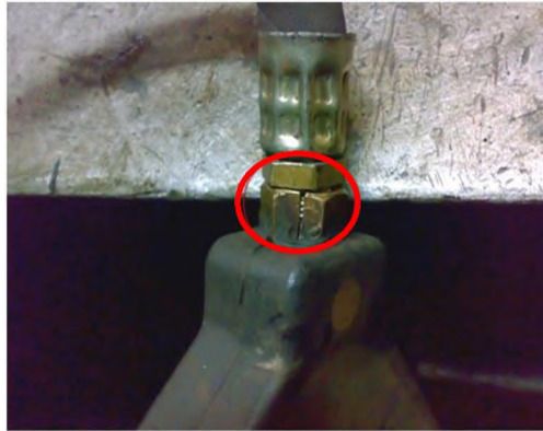
Şekil 4.25 Hava yastığının nipel kısmının çatlaması.
