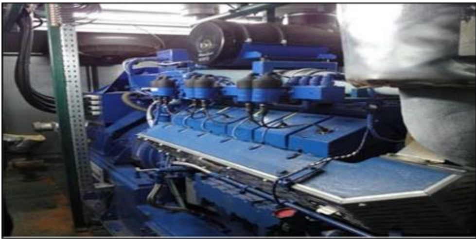
Şekil 1.27 Biyogaz tesislerinde kullanılan Gaz-Otto Motor (Yokuş, 2011)
