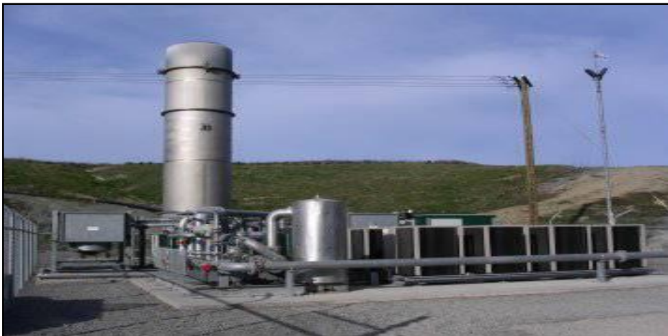
Şekil 1.23 Yeni Zelanda'da inşa edilmiş bir çöp gazı geri kazanım tesisi (Yokuş, 2011)
