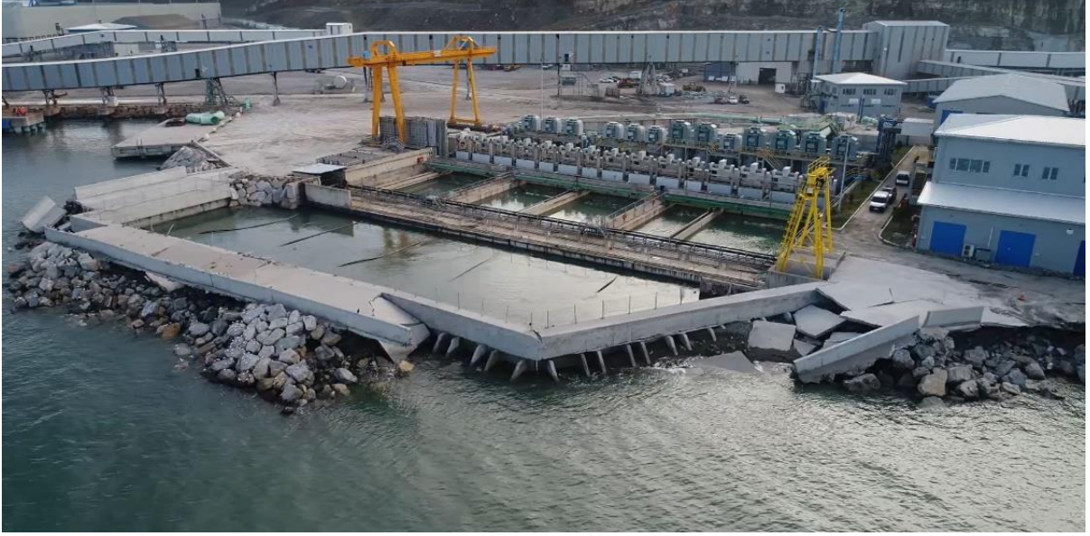
Şekil 4.12 Eren Limanı Su Alma Yapısı Hasar Görüntüsü
