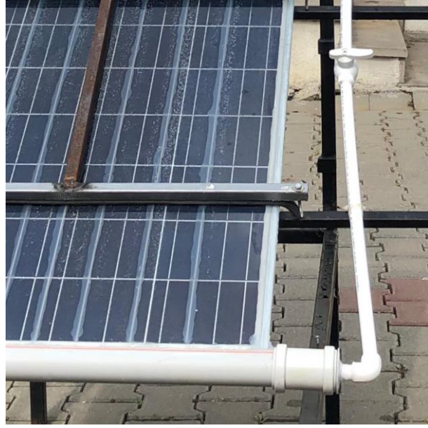
Şekil 3.19 Kollektör giriş bağlantısı ve sistem vanası.
