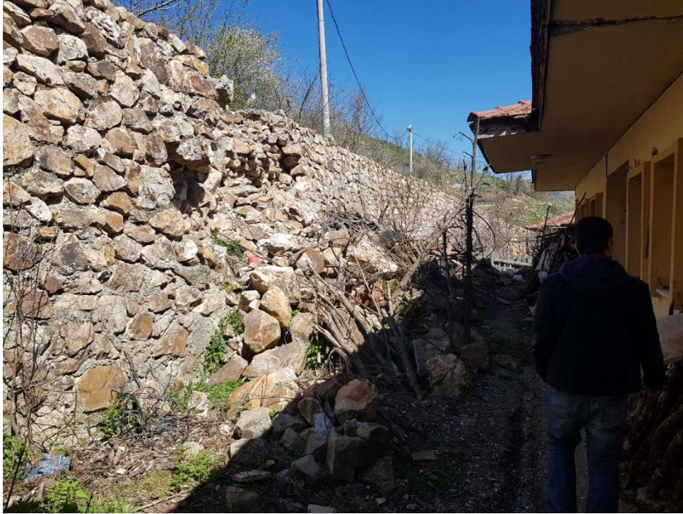
Şekil 8.7 İnceleme alanında hasar görmüş taş duvar.
