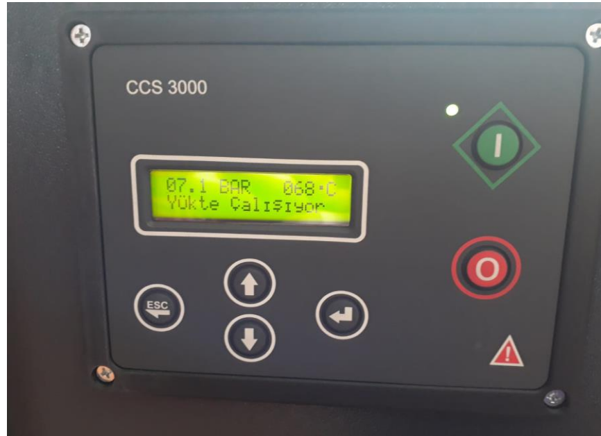
Şekil 3.26. Kompresör kontrol ünitesi
