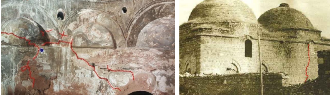
Şekil 4.96. Konak Hamamı sıcaklık mekânı ve I.Murat Hamamı (Yalman 1946) kadınlar bölümü soyunmalık mekânı güney dış duvarlarında ilerleyen yapısal çatlaklar
