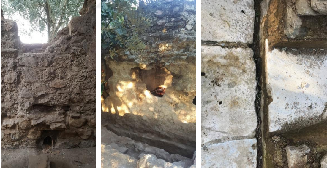
Şekil 3.61. Orhangazi Hamamı pis su sistemi kuzeybatı halveti batı duvarı, kuzeybatı halvet batı dış duvarı, güneybatı halveti ile batı eyvan döşemeleri (kazı sonrası durumu)
