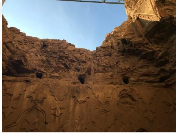
Şekil 4.6. İsmail Bey Hamamı ılıklik birimi batı duvarı geçiş eleman örgüsündeki ahşap hatıl ve bağ hatıl boşlukları
