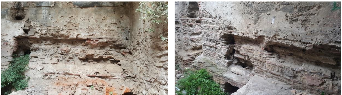
Şekil 4.94. Yeşil Cami Hamamı kuzey ve güney eyvan duvarları kâgir duvar enkesit azalmaları
