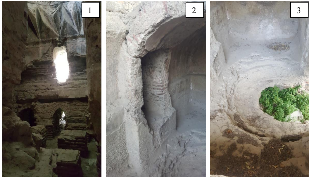
Şekil 3.39. İsmail Bey Hamamı 1) güneydoğu halvetinden su deposuna açılan kontrol penceresi boşluğu, 2) su deposu ve kontrol penceresi boşluğu, 3) suyun ısıtıldığı bakır kazan boşluğu
