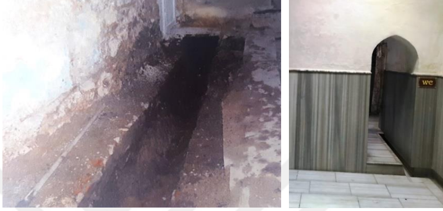
Şekil 3.27. II.Murat Hamamı esaslı onarım öncesi erkekler bölümü soyunmalık mekânı zemininden çıkarılmış özgün pis su kanalı (BKVKBK 2011), erkekler bölümü ılıklik mekânından temizlik hücreğine ulaşan pis su kanalı
