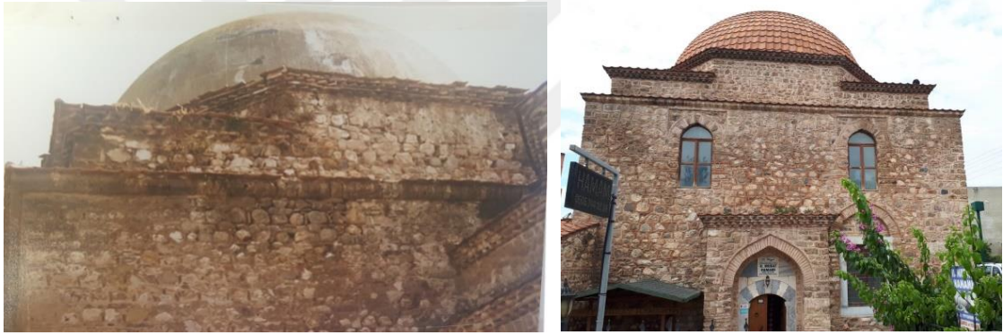
Şekil 4.118. II.Murat Hamamı erkekler bölümü soyunmalık mekânı kuzey dış duvarındaki yüzey kirliliği (BKVKBK 2002), II.Murat Hamamı erkekler bölümü soyunmalık mekânı güney dış duvarı restorasyon sonrası oluşan yüzey kirliliği
