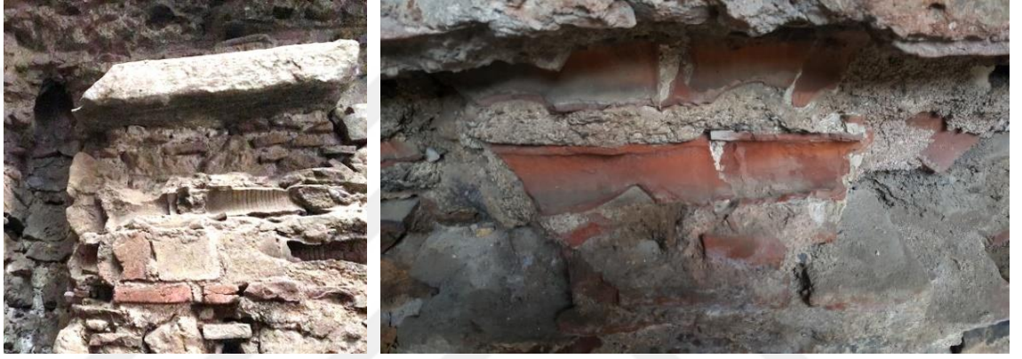
Şekil 4.133. İsmail Bey Hamamı güneydoğu halveti doğu duvarı, Yeşil Cami Hamamı güney eyvanı künk hasarları
