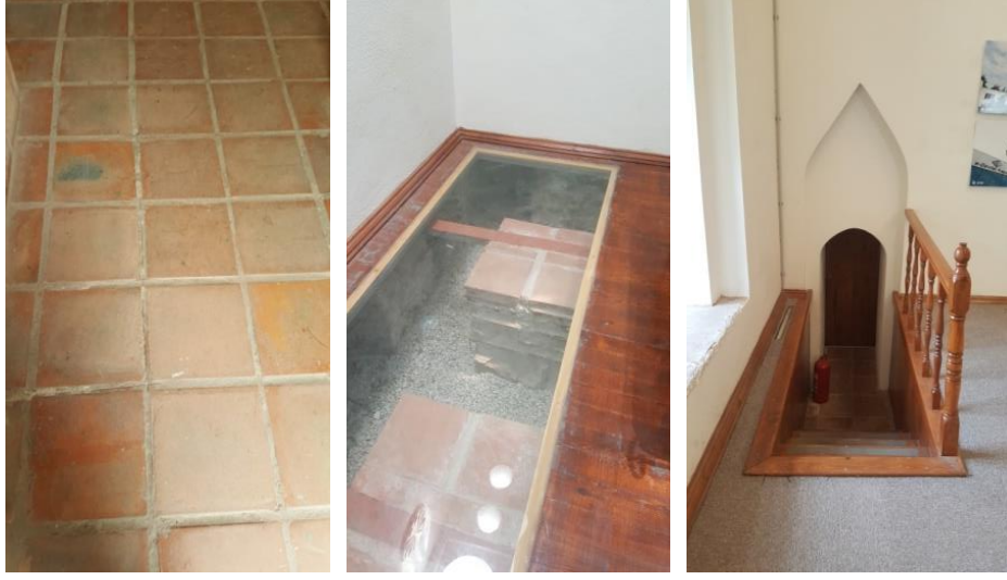
Şekil 3.6. I.Murat Hamamı kadınlar bölümü soyunmalık, sıcaklık ve halvetler ile erkekler bölümü soyunmalık mekânı özgün olmayan döşeme kaplamaları
