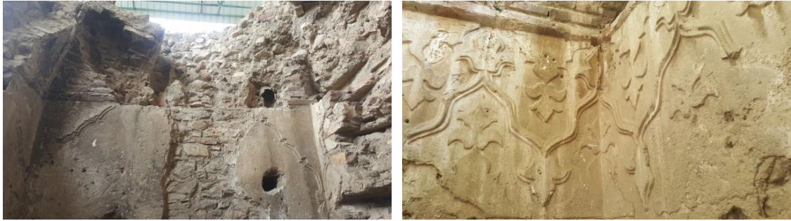
Şekil 4.131. İsmail Bey Hamamı ılıklık mekânı ve ılıklık birimi duvar bezemelerindeki kısmi form kayıpları
