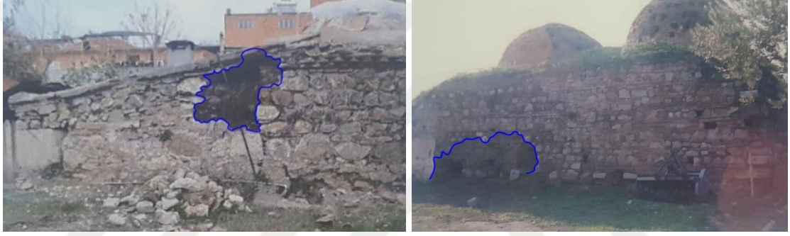
Şekil 4.92. II.Murat Hamamı güney duvarı, İsmail Bey Hamamı dış duvar örgüsünde gevşeme ve kayıp (BKVKBK 2011, 1989)
