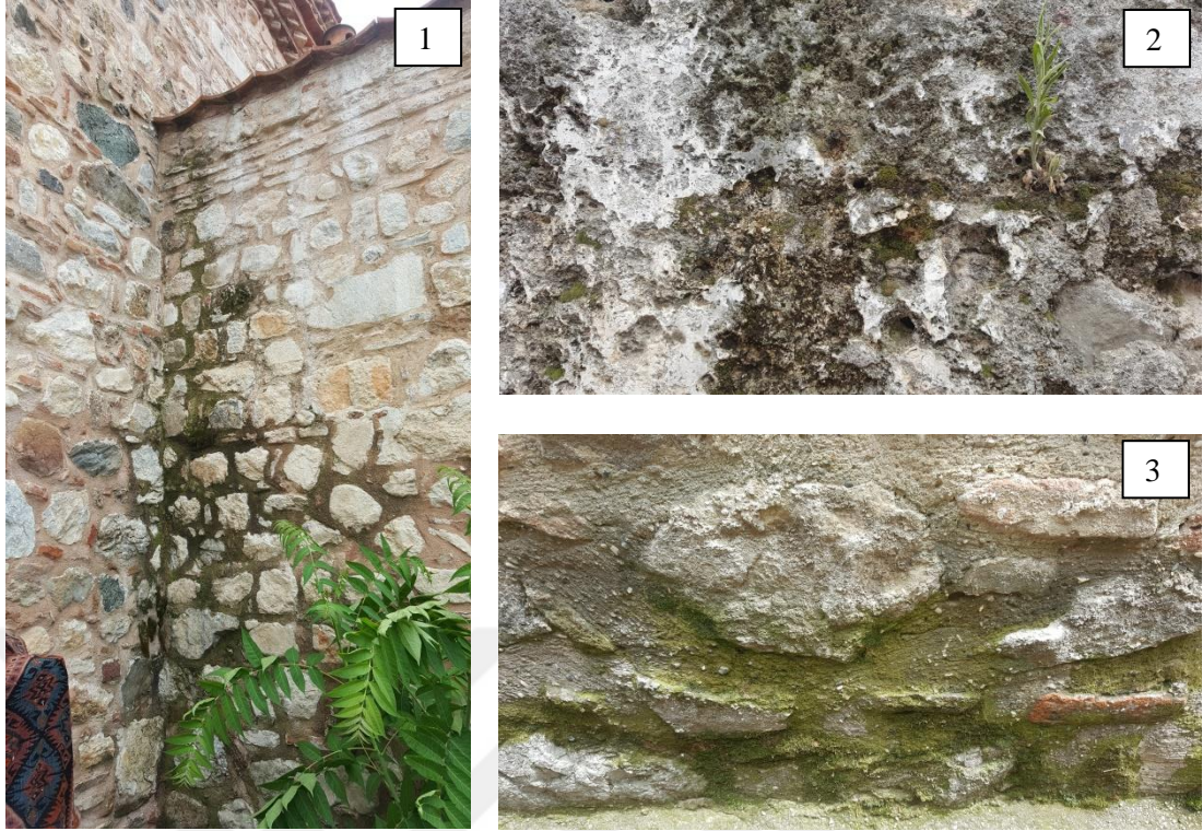
Şekil 4.126. 1) II.Murat Hamamı kadınlar bölümü soyunmalık mekânı ve sıcaklık ana mekân duvarı, 2) Küçük Hamam güney duvarı, 3) I.Murat Hamamı erkekler bölümü dış duvarlardaki yosun oluşumları
