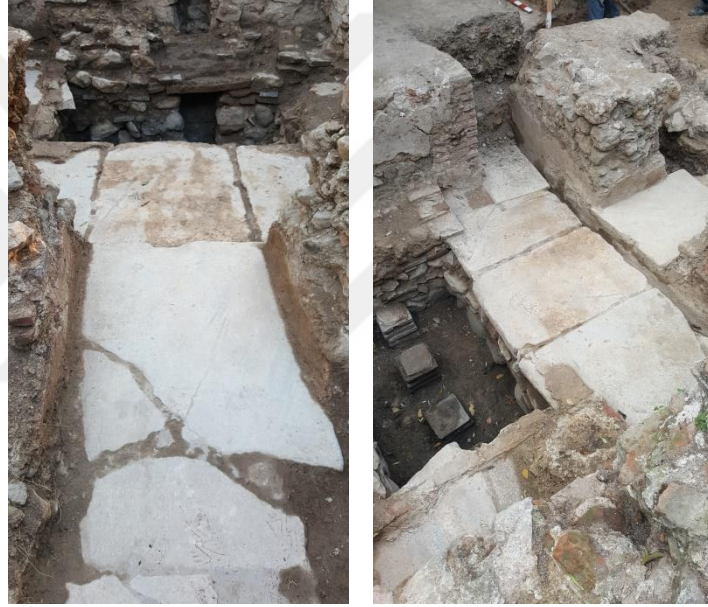
Şekil 4.129. Orhangazi Hamamı özgün döşeme deformasyonları
