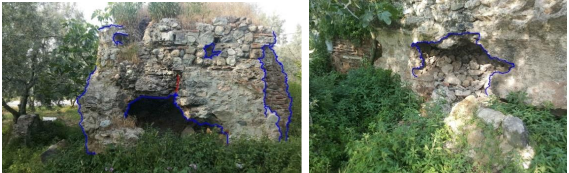
Şekil 4.90. Orhangazi Hamamı kuzeybatı halveti duvar örgüsünde gevşeme ve kayıp (kazi öncesi durumu)
