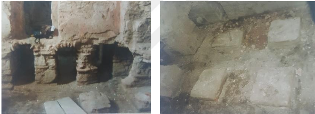
Şekil 4.76. I.Murat Hamamı esaslı onarım öncesi cehennemlik kanalları ve yığma ayak kalıntıları (BKVKBK 2007)
