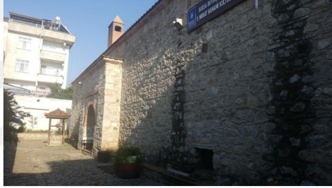
Şekil 4.116. I.Murat Hamamı su deposu ve külhan dış duvarlarındaki renk değişimleri
