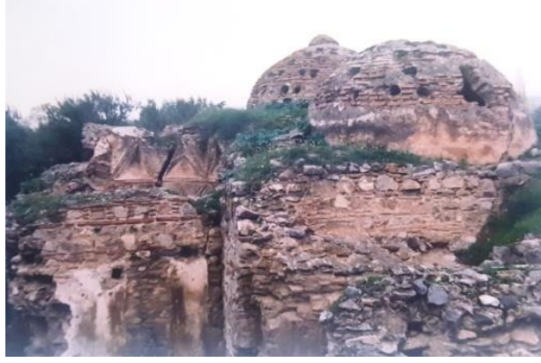
Şekil 4.88. İsmail Bey Hamamı güneydoğu halvet kubbesindeki kopma ve göçmeler (BKVKBK 1989)
