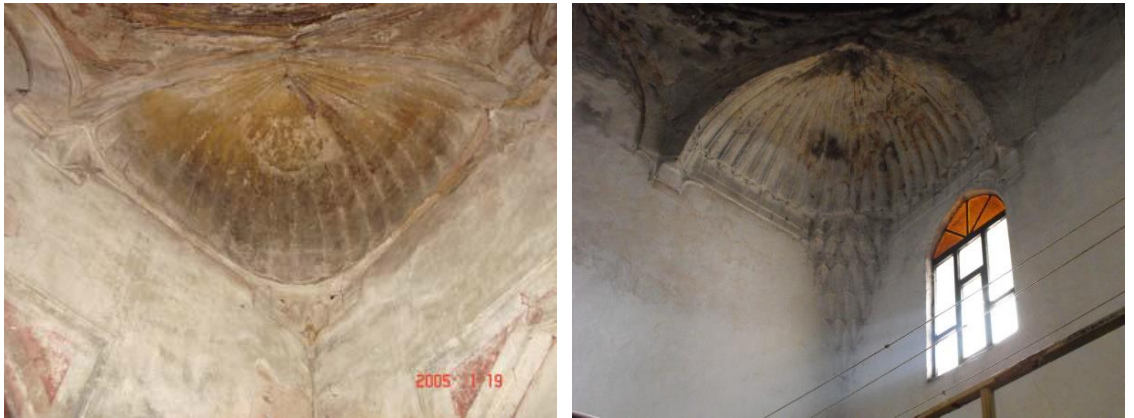
Şekil 4.31. I.Murat Hamamı ve II.Murat Hamamı erkekler bölümü soyunmalık mekânları dilimli trompları esaslı onarım öncesi durumu (Kula Say 2007)
