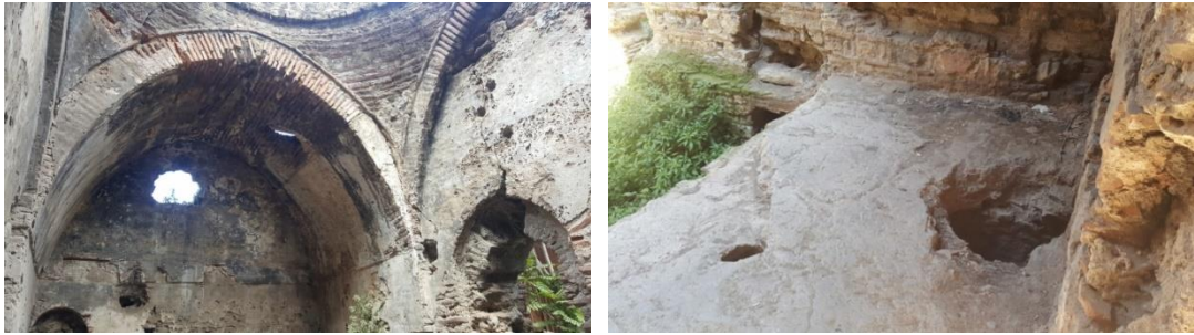
Şekil 4.89. Yeşil Cami Hamamı kuzey halveti tonozu ve güney eyvanı döşemesinde gözlenen göçmeler
