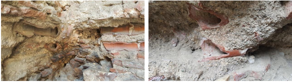
Şekil 4.59. Yeşil Cami Hamamı güney eyvanı güney ve doğu duvarlarındaki paralel iki sıra künk dizimi
