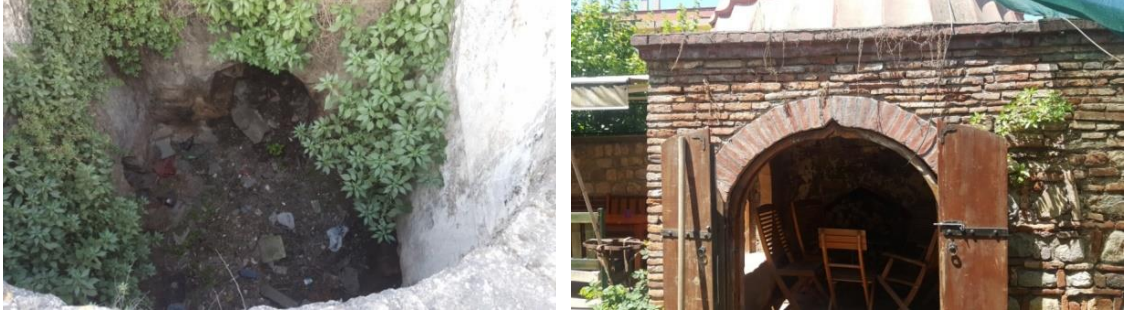
Şekil 4.122. Küçük Hamam sıcaklık ana mekân iç duvarları ve Konak Hamamı beden duvarlarındaki bitki büyümeleri
