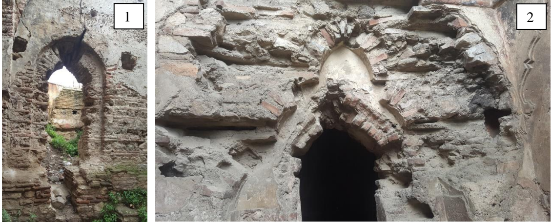
Şekil 4.95. 1) Yeşil Cami Hamamı, 2) İsmail Bey Hamamı kapı boşluk kemerlerindeki malzeme kopmaları
