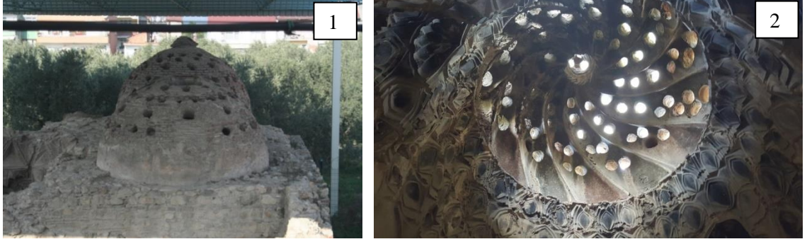
Şekil 3.38. İsmail Bey Hamamı 1) mevcut kubbelerin dıştan görünümü (BBB 2016), 2) sıcaklık ana mekân kubbesinin içten görünümü
