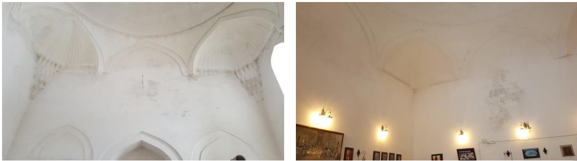
Şekil 3.20. II.Murat Hamamı erkekler bölümü soyunmalık mekânı dilimli tromp, kadınlar bölümü soyunmalık mekânı işlemsiz tromp uygulamaları
