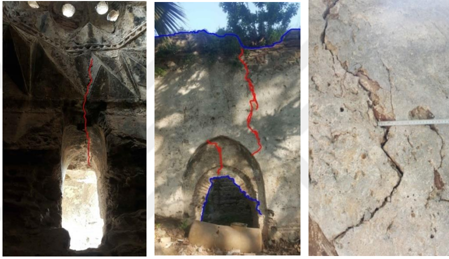
Şekil 4.100. İsmail Bey Hamamı güneydoğu halveti güney duvarı, Yeşil Cami Hamamı erkekler bölümü soyunmalık mekânı doğu duvarı çatlak hareketleri ve ölçülen çatlak genişliği
