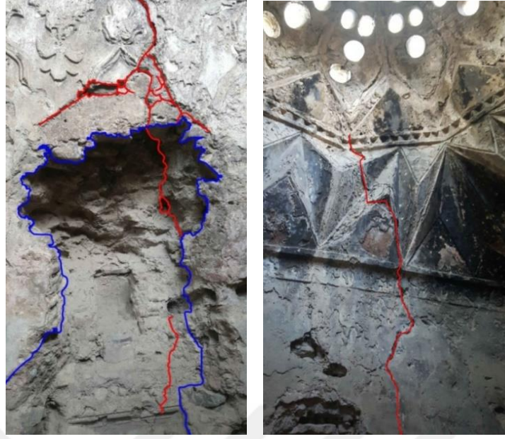
Şekil 4.98. İsmail Bey Hamamı ılıklik birimi ve güneydoğu halvet duvarı çatlak ve hasarları
