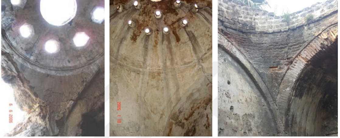
Şekil 4.34. I.Murat Hamamı ılıklik birimleri, II.Murat Hamamı kadınlar bölümü sıcaklik ana mekân pendantifi esaslı onarım öncesi durumu (Kula Say 2007), Yeşil Cami Hamamı pendantifleri
