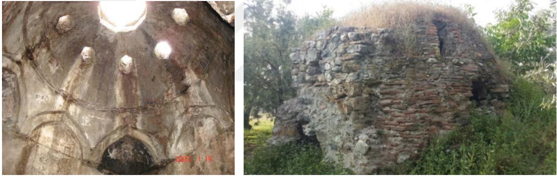
Şekil 4.41. I.Murat Hamamı esaslı onarım öncesi kadınlar bölümü halvet kubbesi (Kula Say 2007), Orhangazi Hamamı kuzeybatı halvet kubbesi (kazı öncesi durumu)
