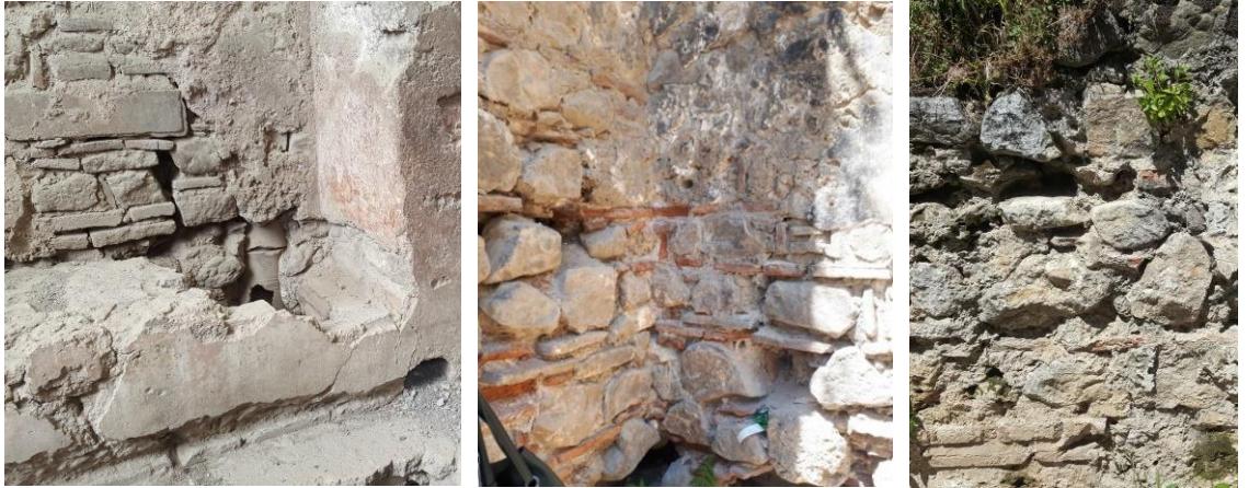
Şekil 4.110. İsmail Bey Hamamı ılık mekânı kuzey duvarı, Yeşil Cami Hamamı kadınlar bölümü soyunmalık mekânı batı duvar kalıntısı, Küçük Hamam güney duvarında bağlayıcı harcın çözülmesi
