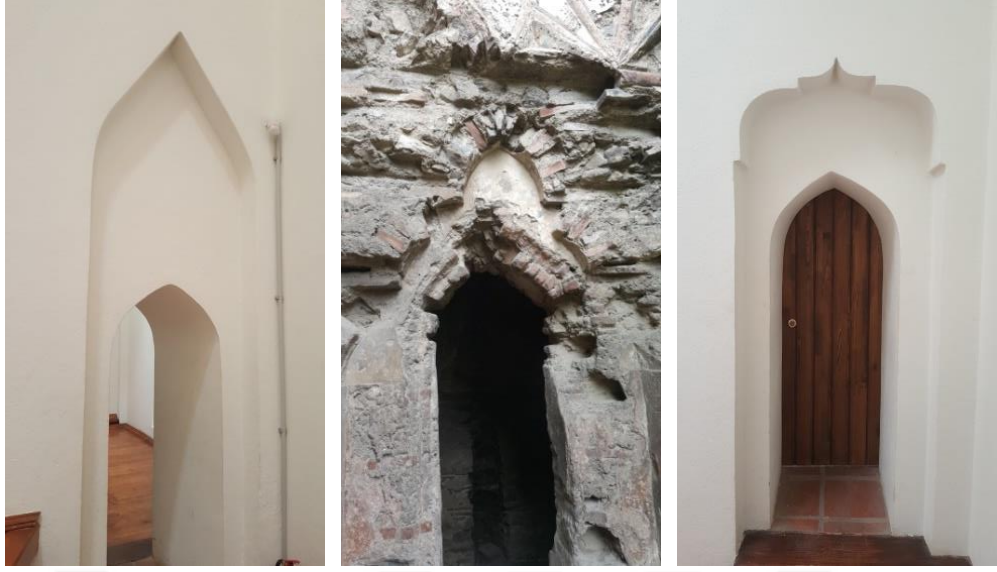
Şekil 4.26. I.Murat Hamamı sivri kemer kademeli, İsmail Bey Hamamı sivri kemer kademeli, I.Murat Hamamı Bursa kemeri kademeli, sivri kemerli geçiş açıklıkları
