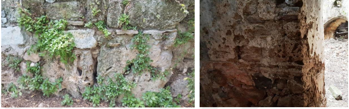
Şekil 4.114. Orhangazi Hamamı su deposu kuzey duvarı ve Küçük Hamam ılıklik mekânı doğu duvarı küfeki malzemede zamanla oluşan büyük boşluklar
