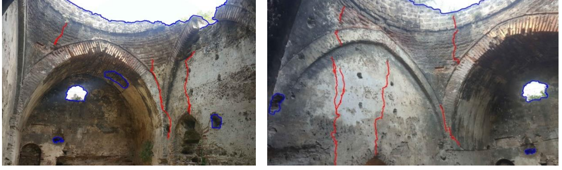
Şekil 4.99. Yeşil Cami Hamamı erkekler bölümü sıcaklık ana mekân doğu ve batı duvar çatlak hareketleri
