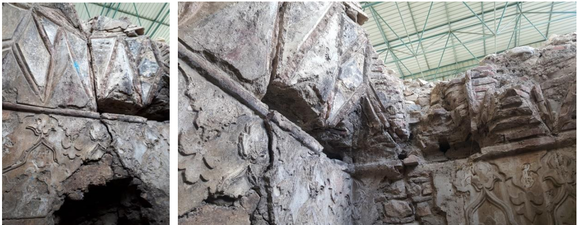
Şekil 4.97. İsmail Bey Hamamı ılıklik birimi geçiş elemanındaki önemli yapısal çatlak ve duvar ile geçiş elemanında oluşan kayma
