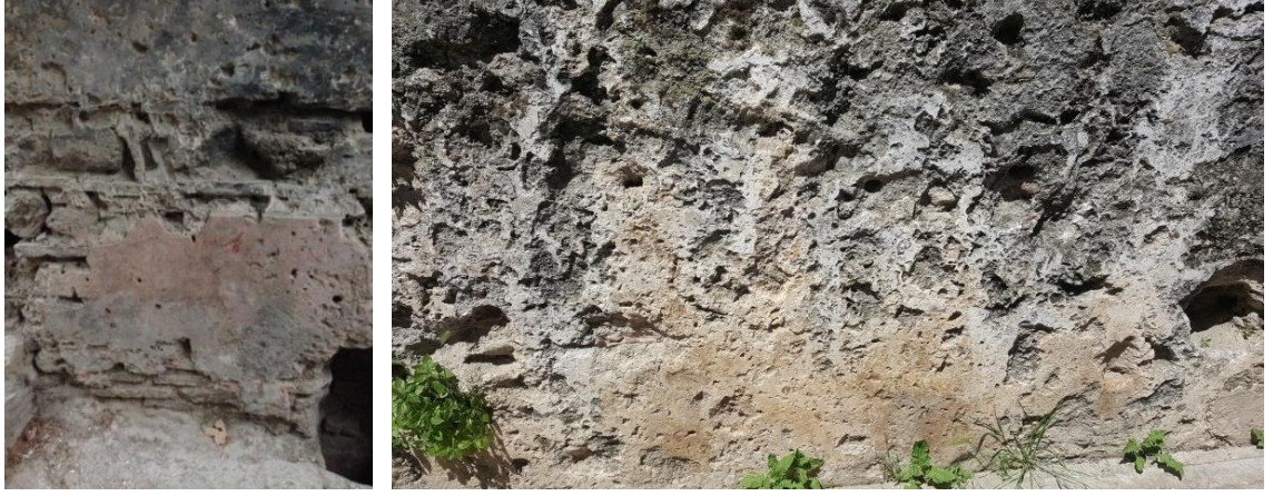
Şekil 4.127. Yeşil Cami Hamamı güney eyvan duvarı ve Küçük Hamam güney duvarı sıva bozulma ve dökülmeleri
