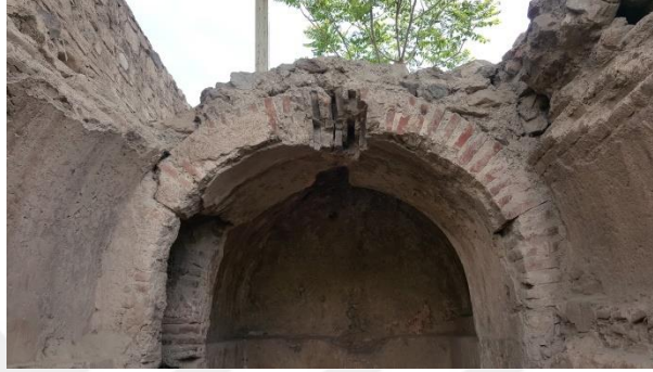
Şekil 4.104. İsmail Bey Hamamı su deposu tonoz hasarları
