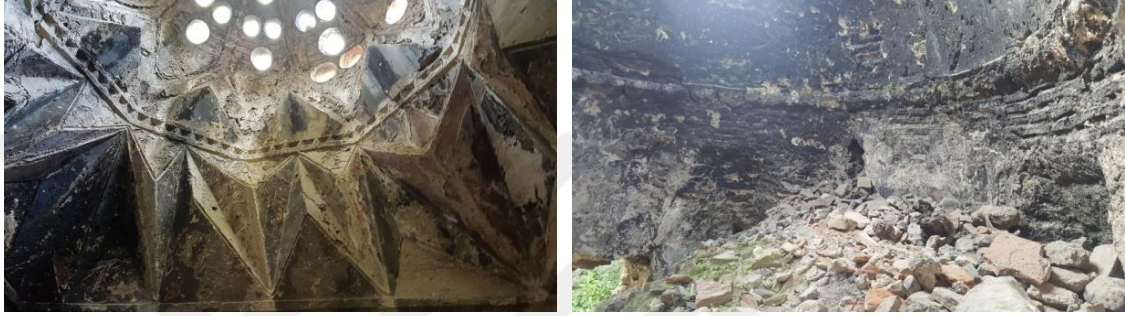
Şekil 4.119. İsmail Bey Hamamı güneydoğu halveti, Orhangazi Hamamı (kazı öncesi durumu) kuzeybatı halveti iç mekândaki kabuk oluşumları
