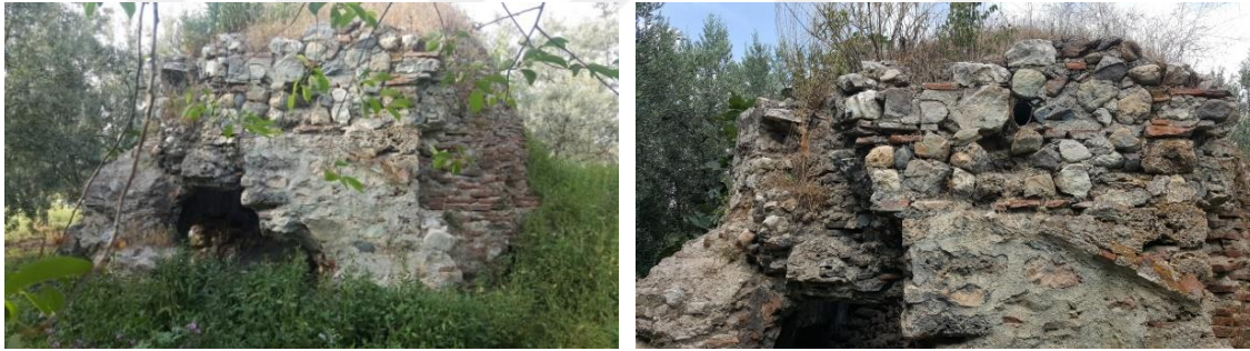
Şekil 4.109. Orhangazi Hamamı kuzeybatı halvet duvarındaki çimento uygulaması (kazi öncesi durumu)
