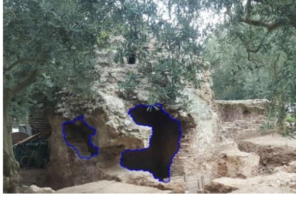
Şekil 4.91. Orhangazi Hamamı kuzeybatı halveti duvar örgüsü gevşeme ve kayıp (kazi sonrası durumu)
