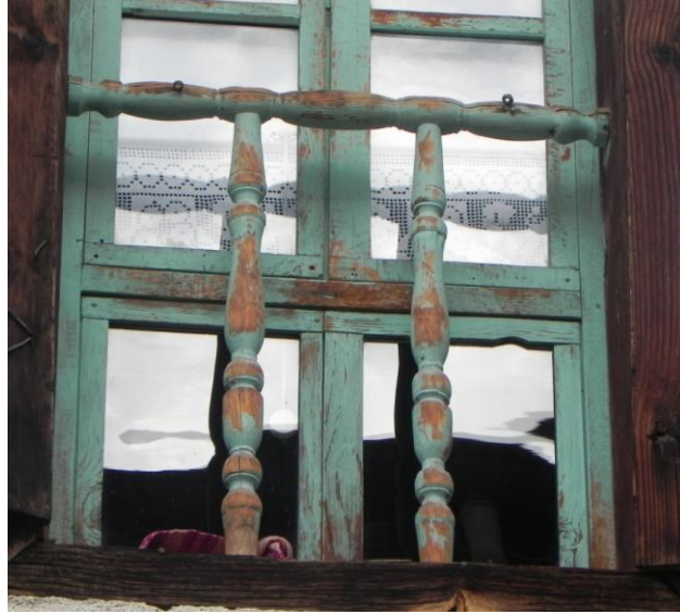
Şekil 3.88. Boya dökülmesi / kabarması örneği.
