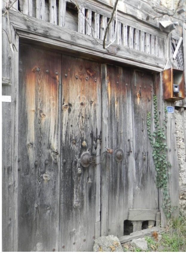
Şekil 4.66. Biçimsel deformasyona maruz kalmış kapı örneği.
