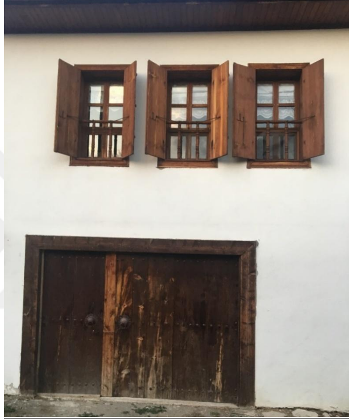
Şekil 3.39. Kara kapakları açık bulunan ev.
