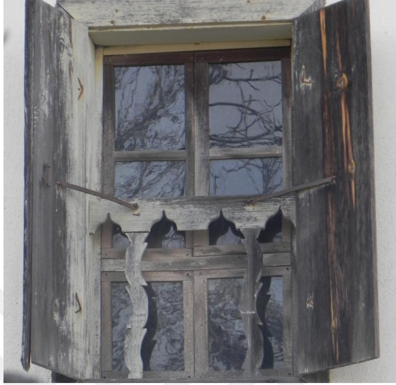
Şekil 4.131. Boya dökülmesi/kabarması olan pencere örneği.
