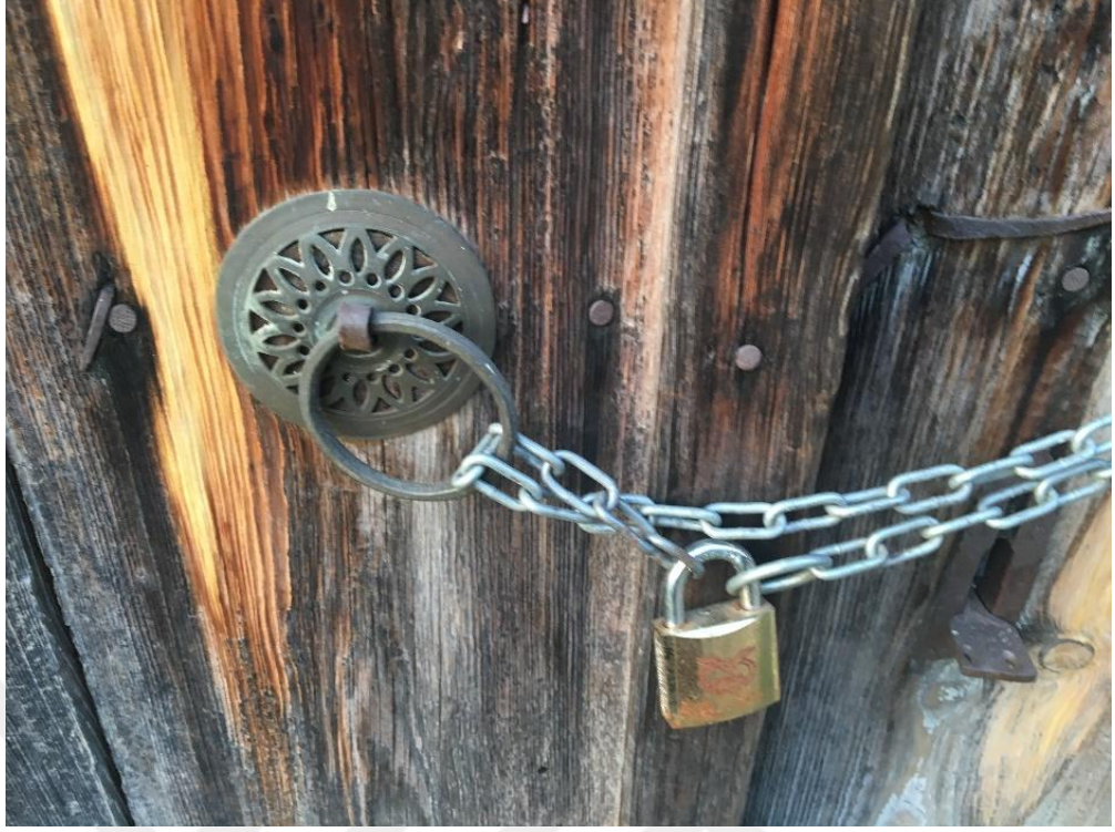
Şekil 4.67. Aşınma görülen kapı örneği.
