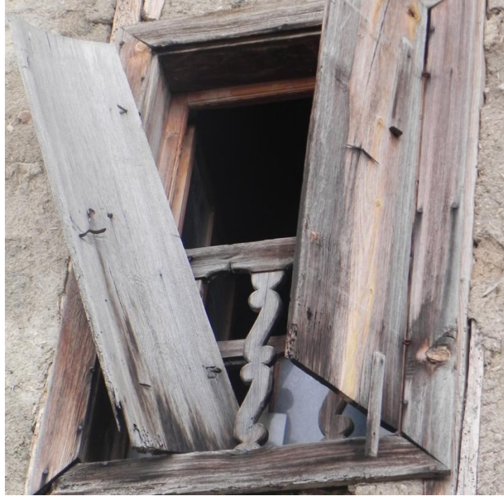
Şekil 4.134. Bağlantı sorunları bulunan pencere örneđi.
