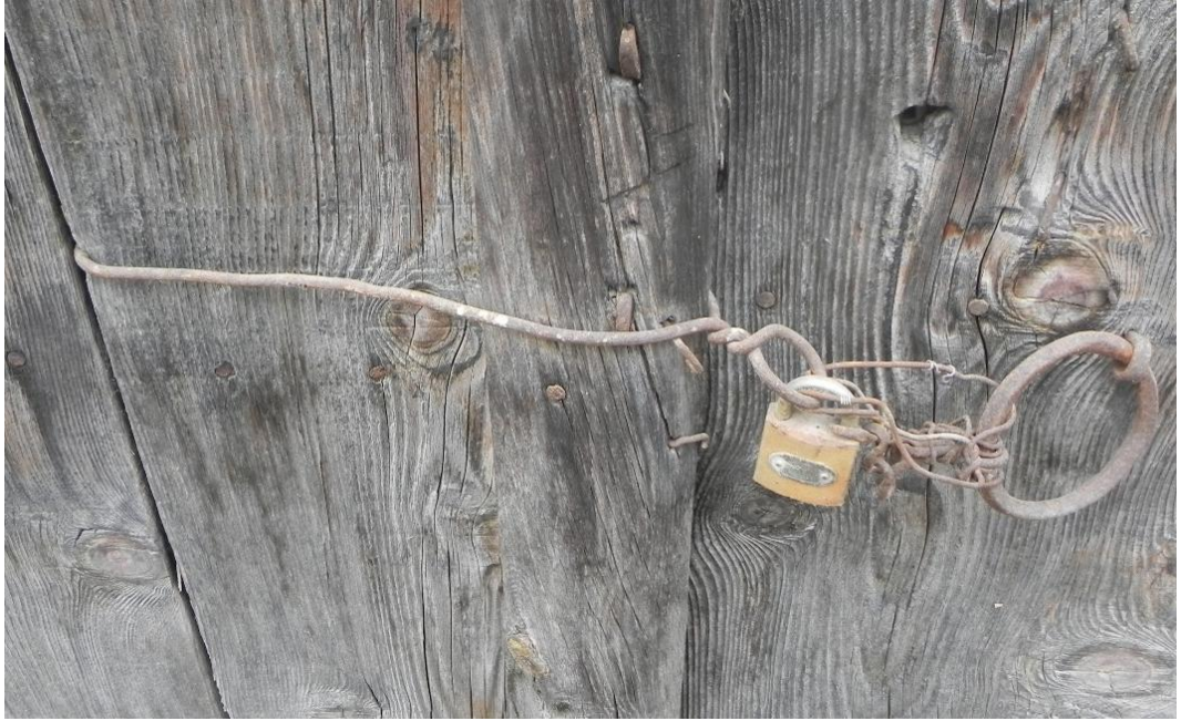
Şekil 4.44. Doğrama üzerinde kilit mekanizması bulunmayan kapı örneği.
