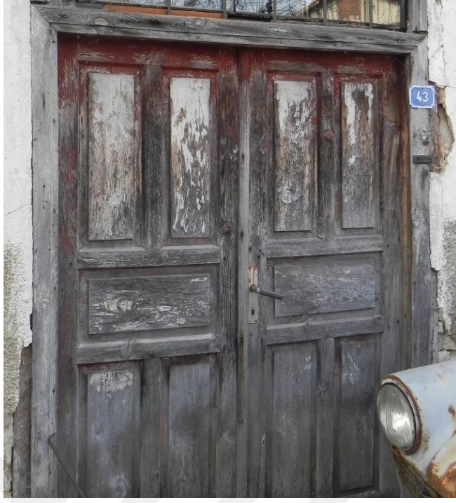
Şekil 4.65. Boya dökülmesi / kabarması görülen kapı örneği.
