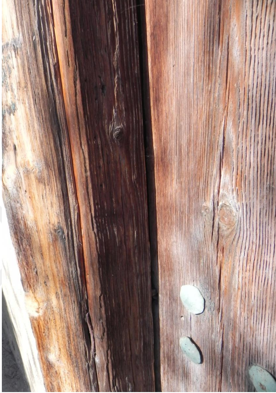
Şekil 3.86. Çatlak oluşumuna örnek.
