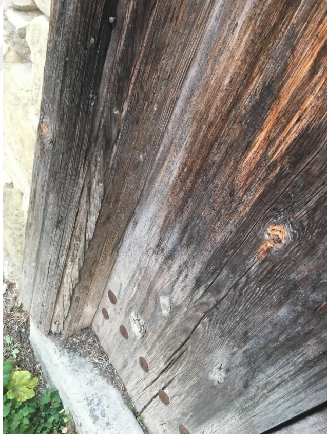
Şekil 4.64. Çatlamaya maruz kalmış kapı örneği.
