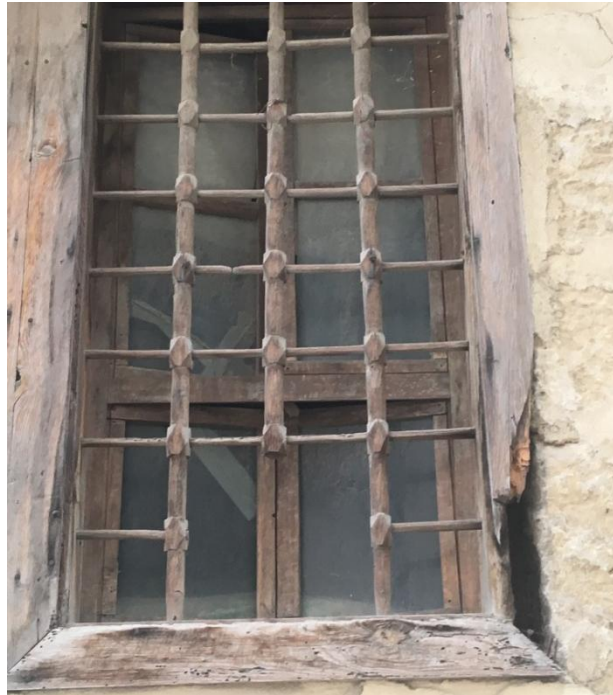
Şekil 4.130. Çatlak / kırık olan pencere örneęi.
