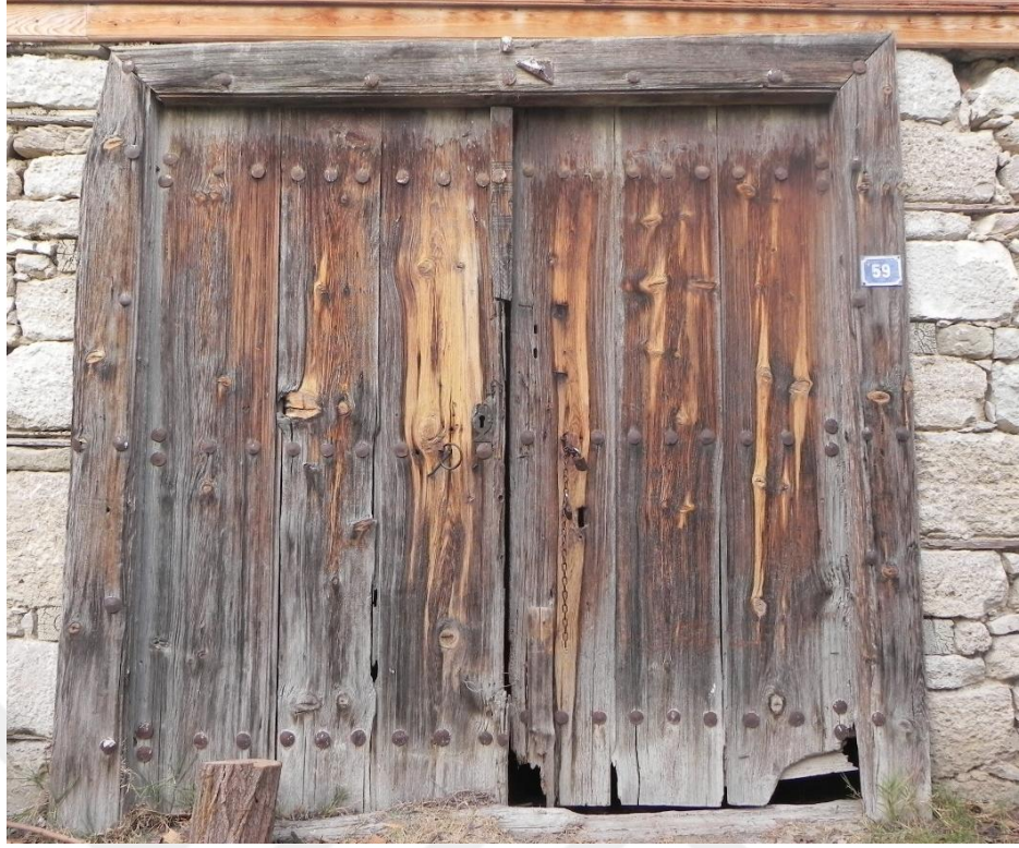
Şekil 4.71. Bağlantı sorunu olan kapı örneği.
