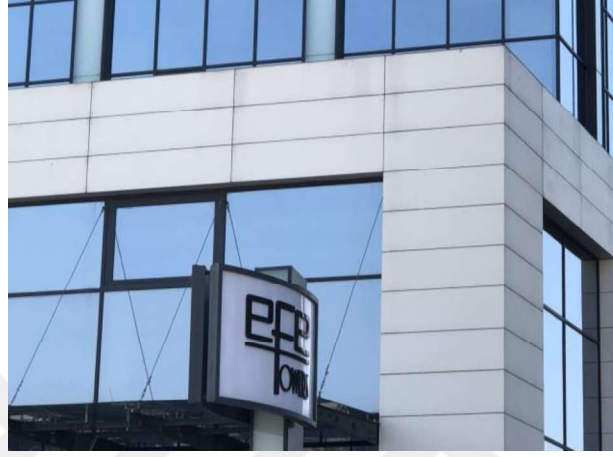
Şekil 4.16. Efe Towers- Yüzey Kirlenmesi
