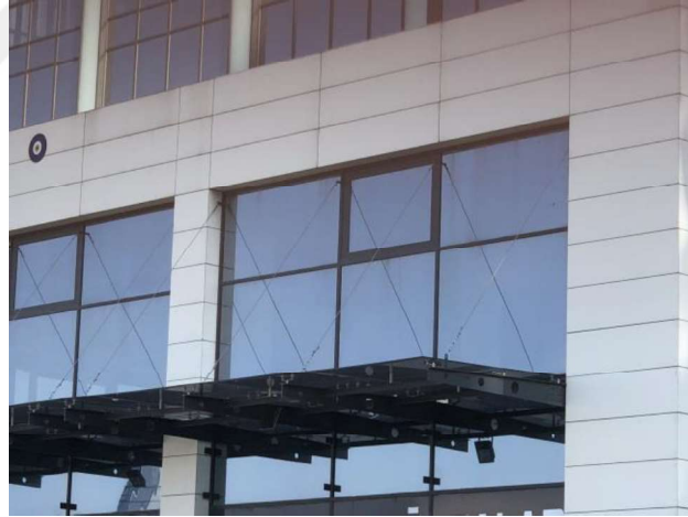
Şekil 4.17. Efe Towers- Yüzey Kirlenmesi
