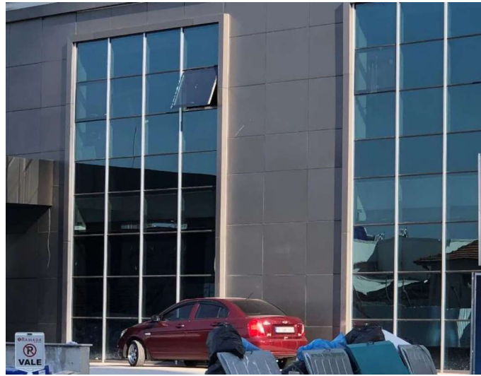
Şekil 4.27 Zorlu-Çelebi Plaza- Yüzey Kirlenmesi ve Lekelenmesi
