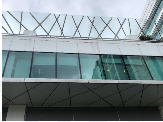
Şekil 4.49 Zeno Center - Yüzey Kirlenmesi
