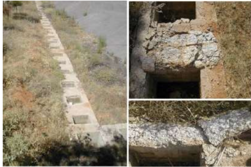
Őekil 2.12. Donma-zlme evrimi sonrası hasar gren Uřak ili – Eřme ilesi betonarme temel (Baradan ve ark. 2002)
