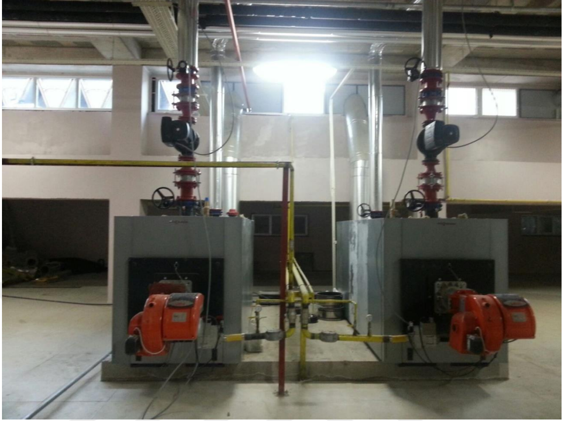
Şekil 4.3. Teknik hacimde bulunan kazanlar.
