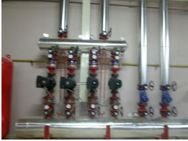
Şekil 4.4. Isıtma kollektörü ve pompalar.
