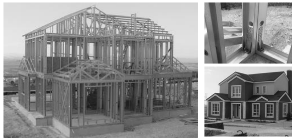
Şekil 2.8. Hafif çelik sistem yapı örneği. İzmir Ulukent’te uygulanan Cordelia evinin yapım sistemi (Terim 2006)
