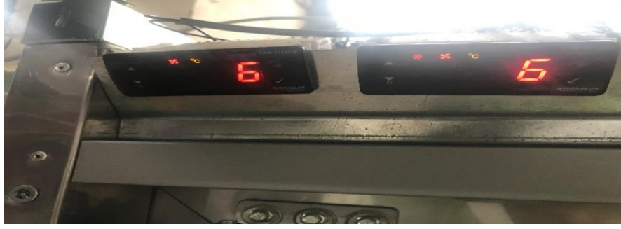
Şekil 4.7. Dolaptaki dijital termostatlar
