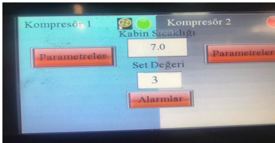
Şekil 4.5. 2-7 °C arasındaki durumlarda HMI görüntüsü
