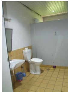
Şekil 4.256. Yıldırım Belediyesi Hacı Saide Zorlu Özel Eğitim İş Uygulama Merkezi spor salonu engelli wc
