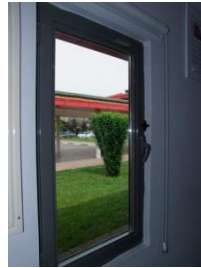
Şekil 4.252. Yıldırım Belediyesi Hacı Saide Zorlu Özel Eğitim İş Uygulama Merkezi el sanatları atölyesi pencere
