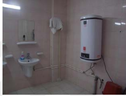
Şekil 4.114. Kayapa Özel Eğitim İş Uygulama Merkezi kat wcleri içinde yer duş mahalli alan üst deęiştirme odası
