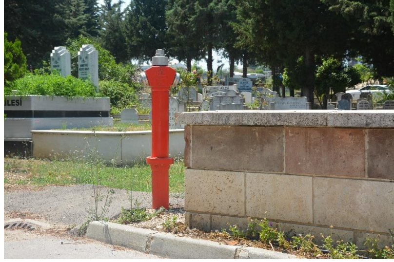
Şekil 4.44. Yerüstü hidrantı (Orijinal)
