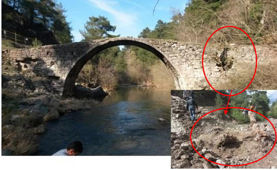
Şekil 3.125. Cüneyt köprüsünün (15. yy.) ayağında her iki cephede de görülen ağaç. Tempan duvar sökülüp, kök temizlenip, ilaçlanıp duvar yeniden örülmüştür
