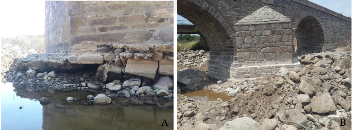
Şekil 3.115. Behramkale Köprüsü a) A4 ayağı temelindeki malzeme kaybı ve oyulma b) Bu ayakta yapılan ampırtman
