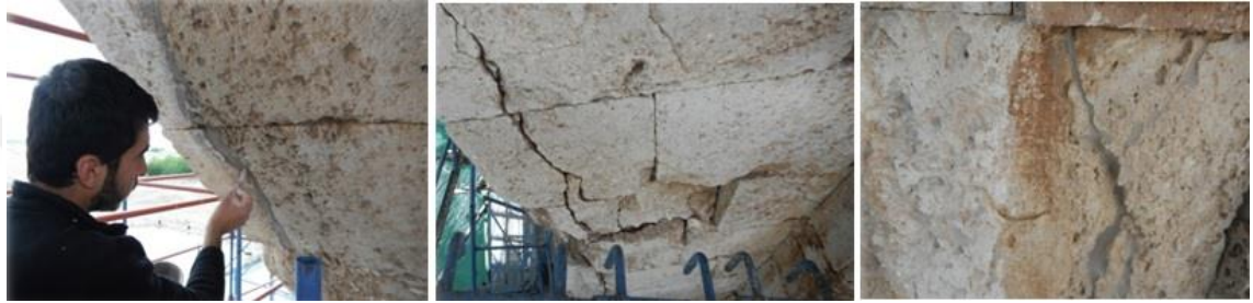
Şekil 3.123. Malabadi köprüsündeki çatlak konservasyonu (Sert ve ark. 2016)
