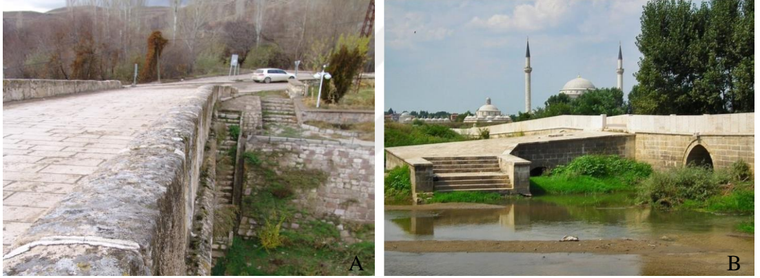
Şekil 3.98. Köprülerdeki merdiven örnekleri a) Şahruh Köprüsü memba yönü (Anonim 2011) b) Yalnızgöz köprüsü, Edirne ( http://www.trakyaagezi.com/mimar-sinan-gezi-yolu-edirne/ , 2018)
