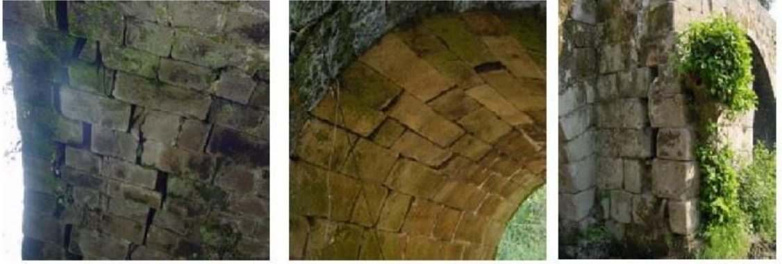
Şekil 3.139. Tarihi Donim Köprüsünde meydana gelen hasarlar (Oliveira ve Lourenço 2004)
