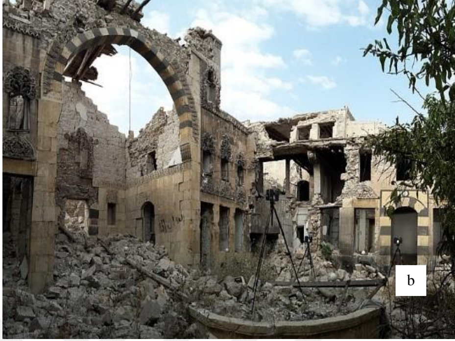
Şekil 61. Açıkbash Evi'nde yaşanan hasar (Anonim 2016f)
