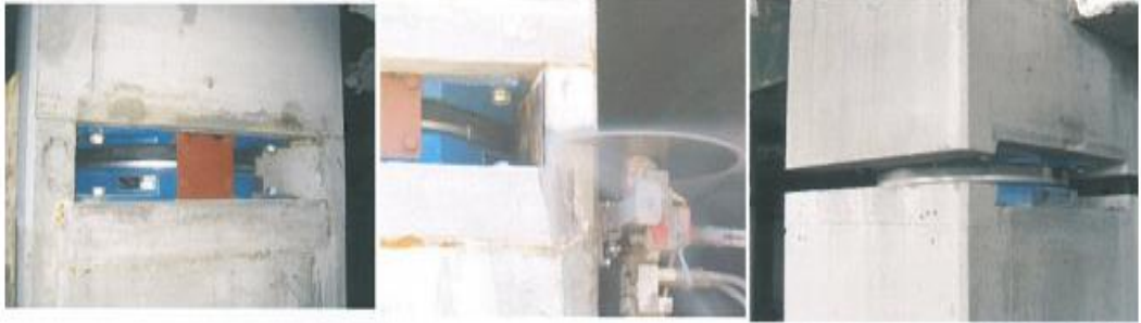
Şekil 2.29 İzolatörlerin kolonlara monte edilmiş hali (Kök 2014)
