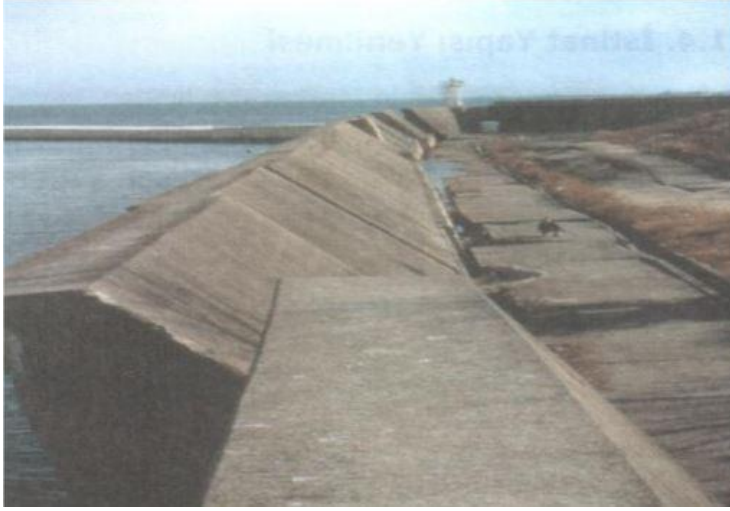
ekil 2.9. 1995 Kobe depreminde olu an hasar
